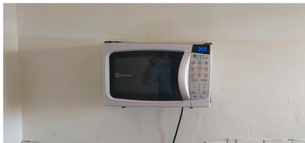
Foto 18 Microondas preso à parede devido a furto
