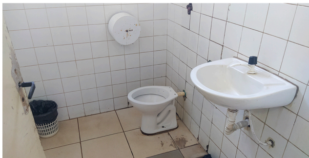
Foto 3 Vaso sanitário sem assento
