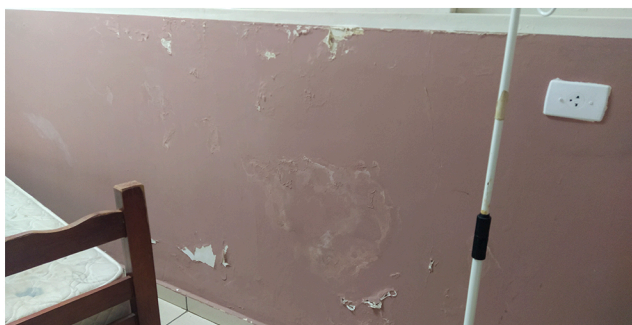
Foto 15 Infiltração nas paredes
