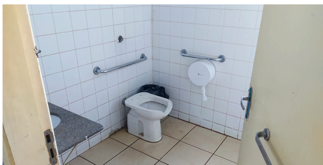
Foto 4 Vaso sanitário sem assento
