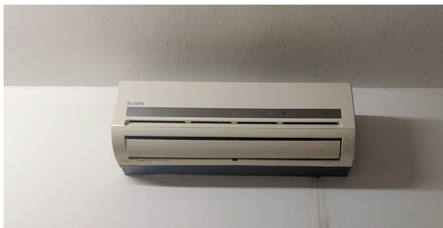
Foto 14 Vazamento no ar-condicionado
