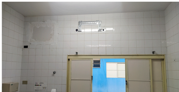
Foto 7 Sala sem ar-condicionado
