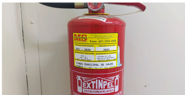
Foto 9 Extintor com manutenção vencida
