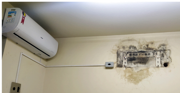
Foto 7 Paredes com infiltração
