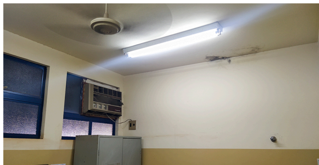
Foto 9 Infiltração e ar-condicionado antigo
