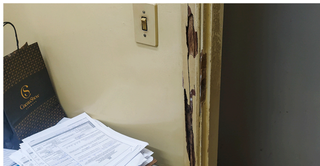
Foto 6 Porta antiga e danificada
