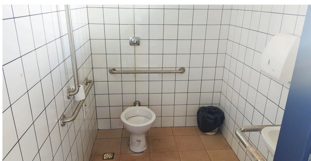
Foto 13 Vaso sanitário sem assento
