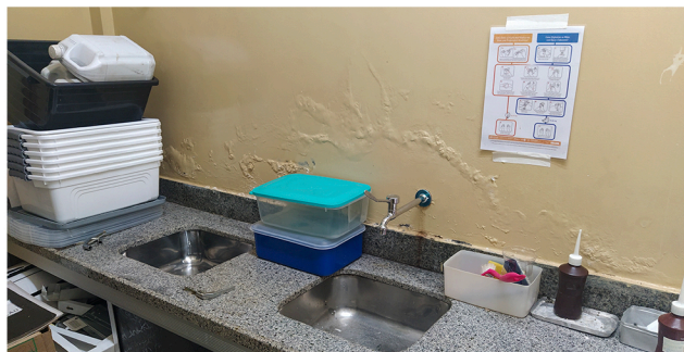
Foto 8 Paredes com infiltração
