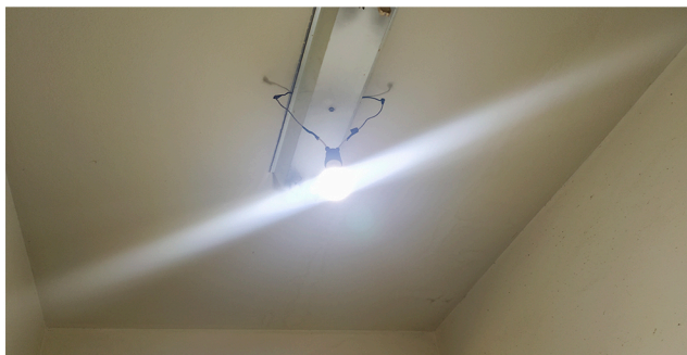
Foto 11 Fiação elétrica exposta
