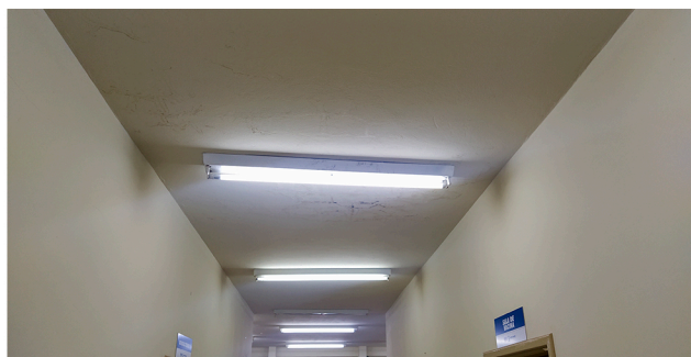
Foto 10 Teto com infiltração
