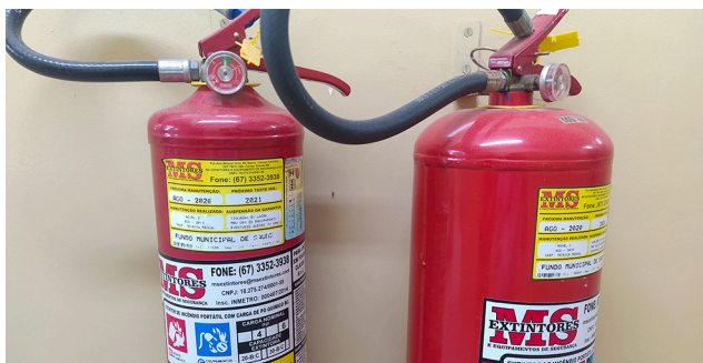
Foto 12 Extintor com manutenção vencida
