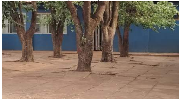
Foto 5: Raízes quebraram piso.
