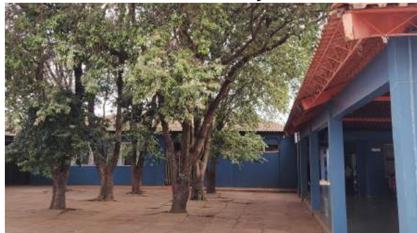
Foto 4: Árvores necessitando de poda.
