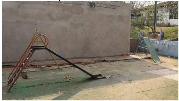
Foto 14: Parquinho necessita reparos.
