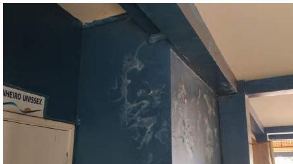
Foto 1: Coluna com infiltração.
