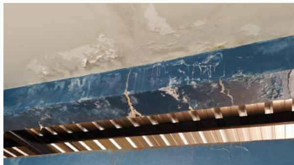
Foto 2: Teto com infiltração.
