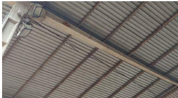
Foto 10: Estruturas sem tela permitem pombos no local.
