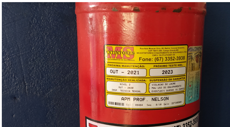
Foto 14 Extintor de incêndio
