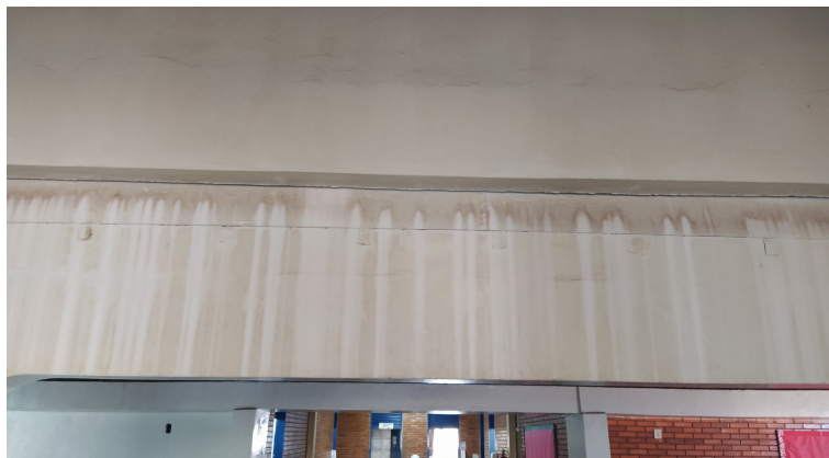
Foto 8 Parede com infiltração
