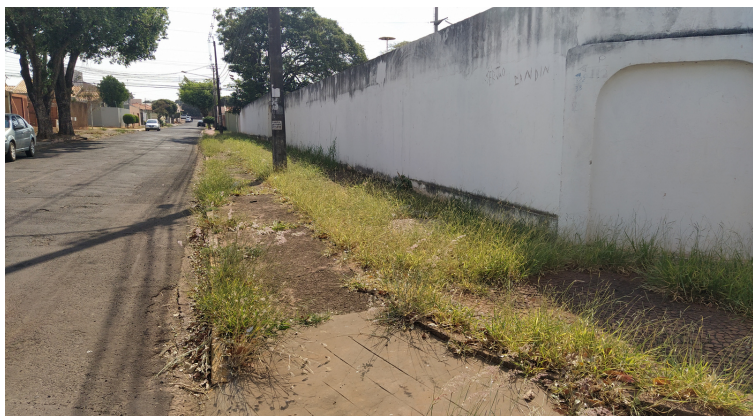
Foto 3 Calçada sem acessibilidade
