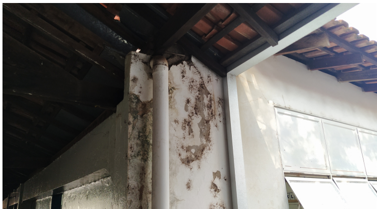
Foto 7 Parede com infiltração
