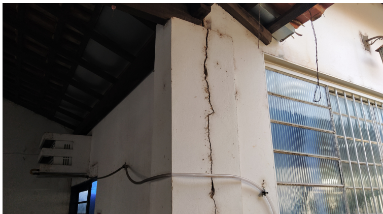
Foto 9 Rachadura na parede
