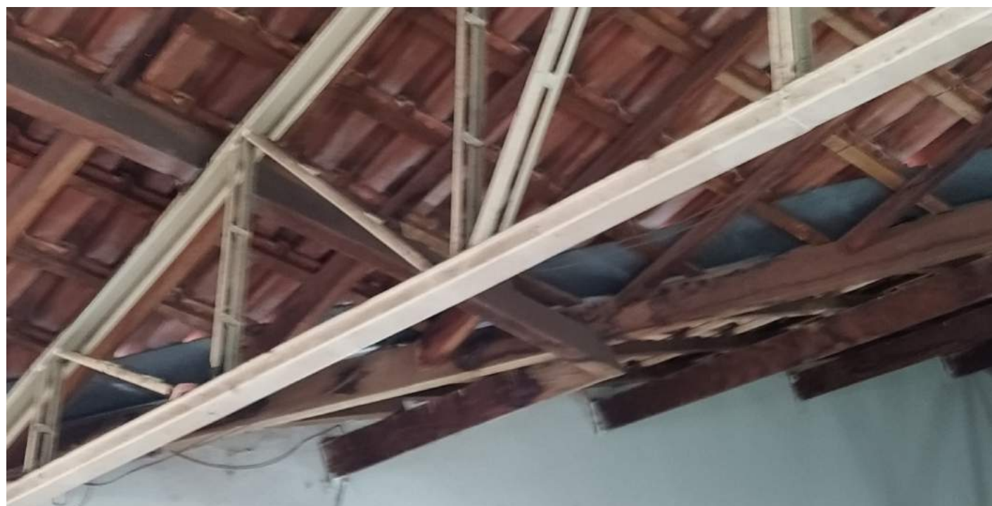
Foto 18: Telhado necessita de manutenção.
