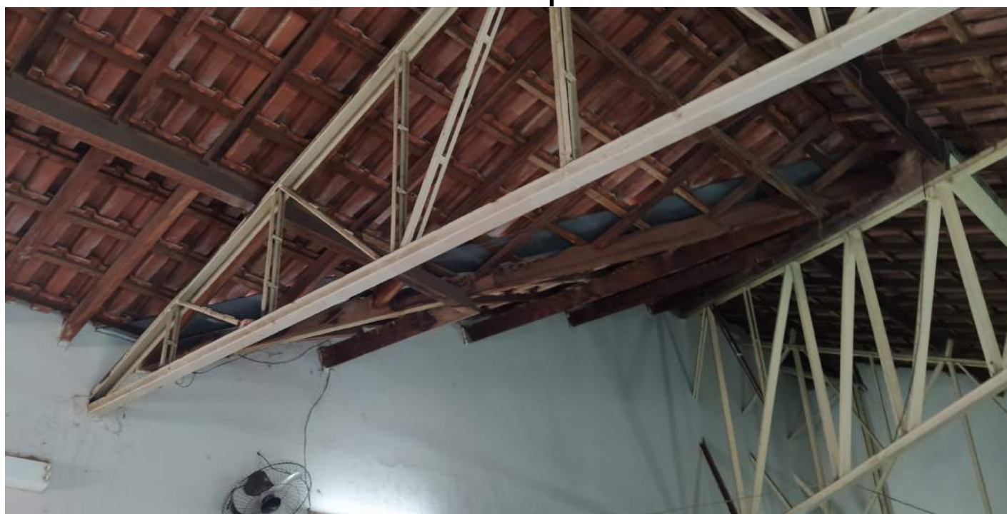
Foto 17: Telhado necessita de manutenção.
