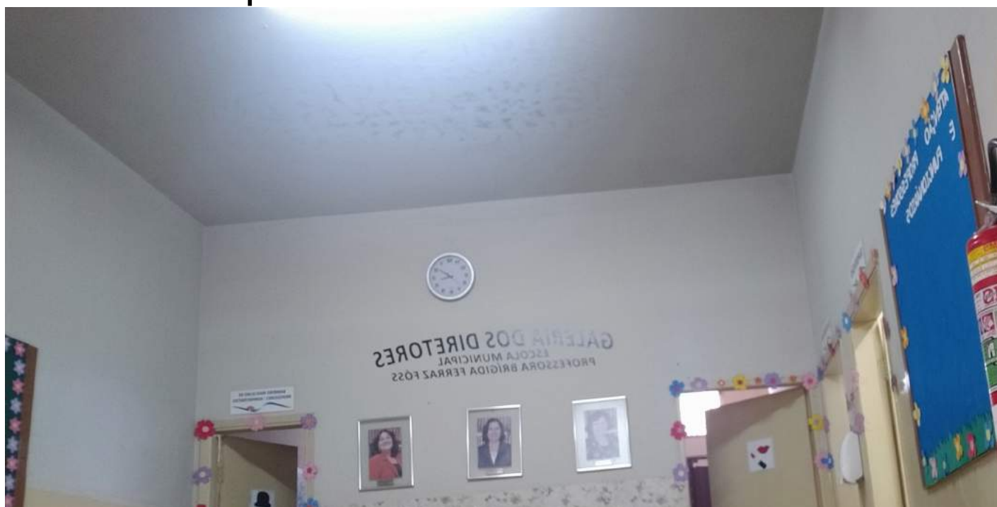
Foto 5: Infiltrações no teto.
