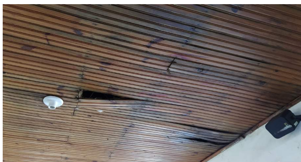
Foto 6: Forro requer reparos/troca.
