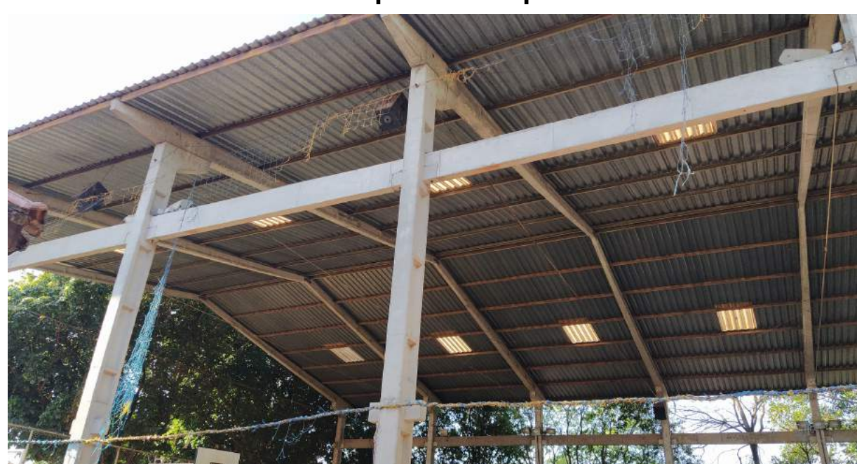
Foto 8: Quadra poliesportiva requer telamento.
