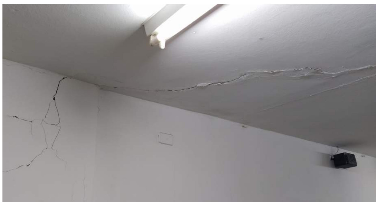
Foto 3: Rachaduras interna no teto.
