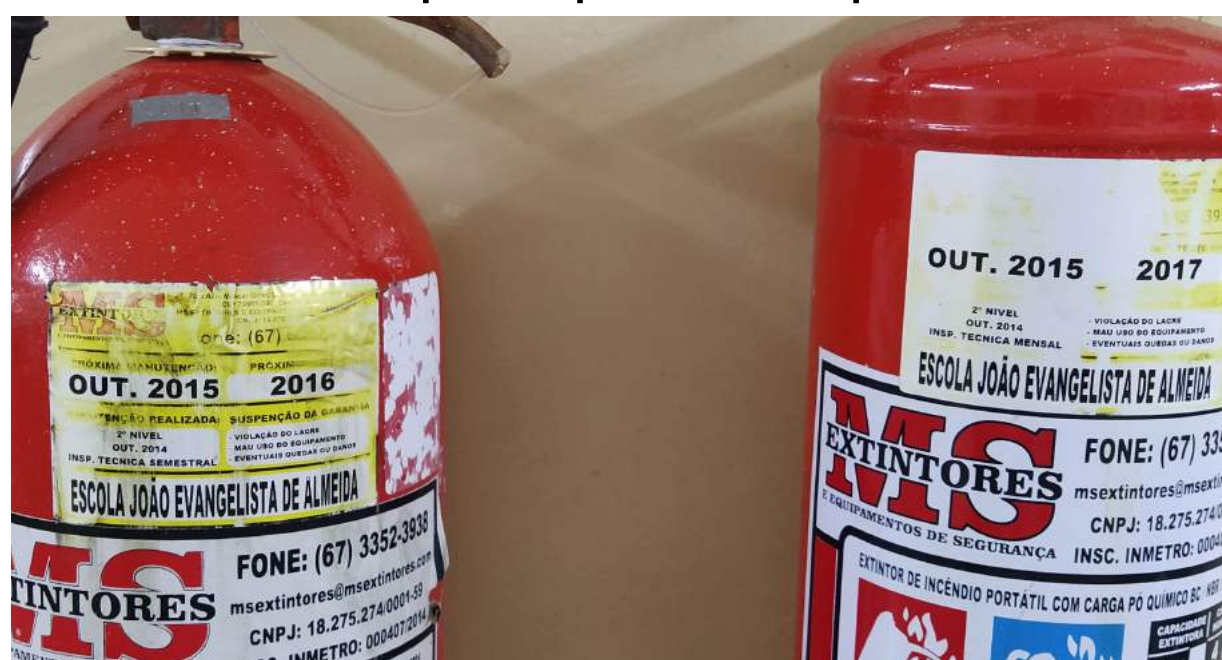
Foto 10: Alguns extintores vencidos.
