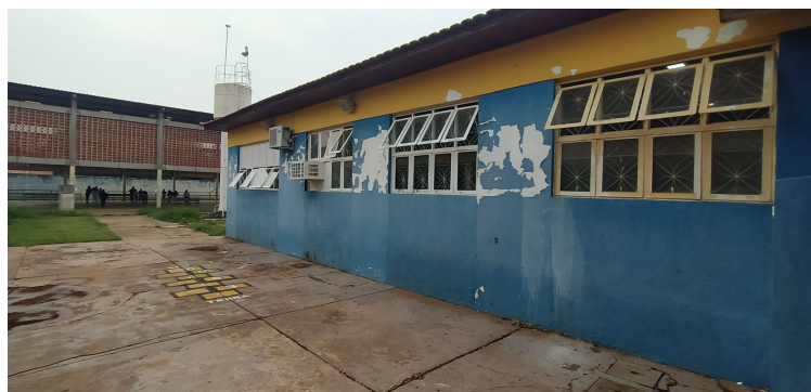
Foto 12 Área externa requer pintura
