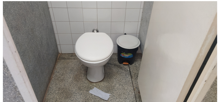
Foto 6 Assento nos vasos sanitários
