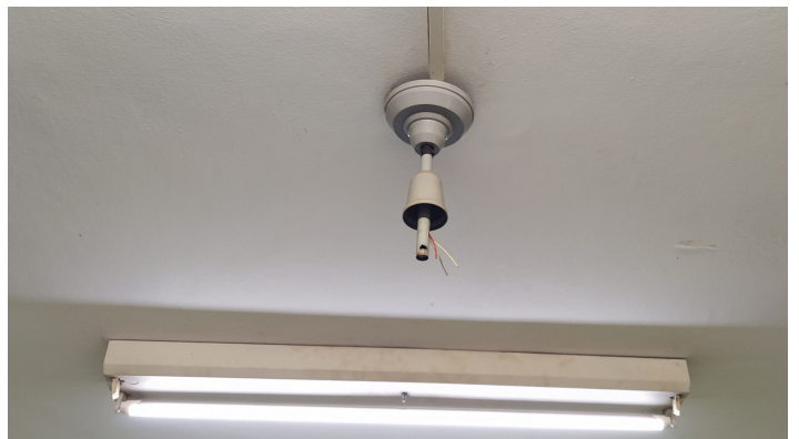
Foto 6: Sala sem ventilador.
