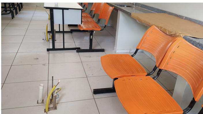
Foto 9: Sala do prédio anexo inacabada.
