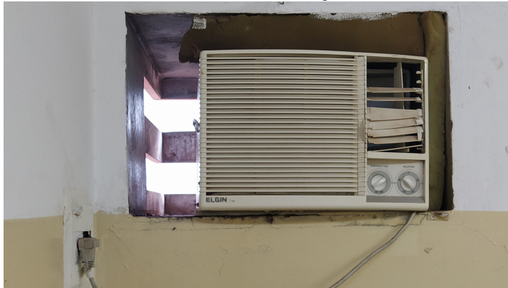
Foto 13: Ar-condicionado da clínica médica.
