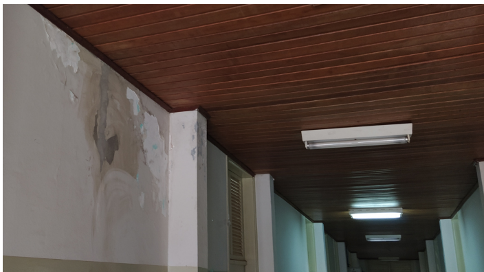
Foto 5: Parede do corredor com infiltrações.
