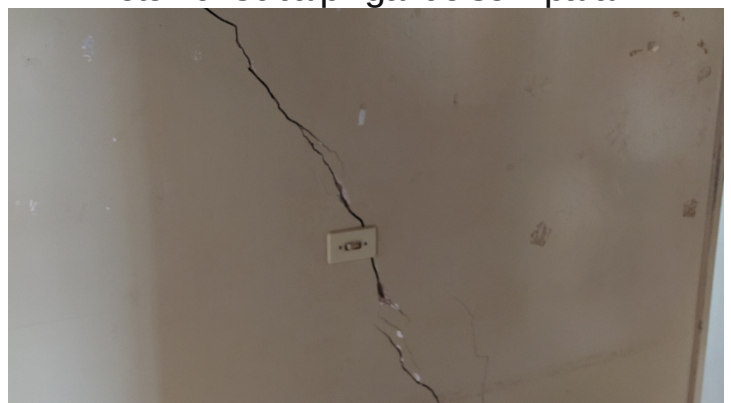
Foto 18: Paredes do corredor com rachaduras.
