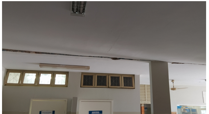
Foto 8: Rachadura no teto do prédio anexo.
