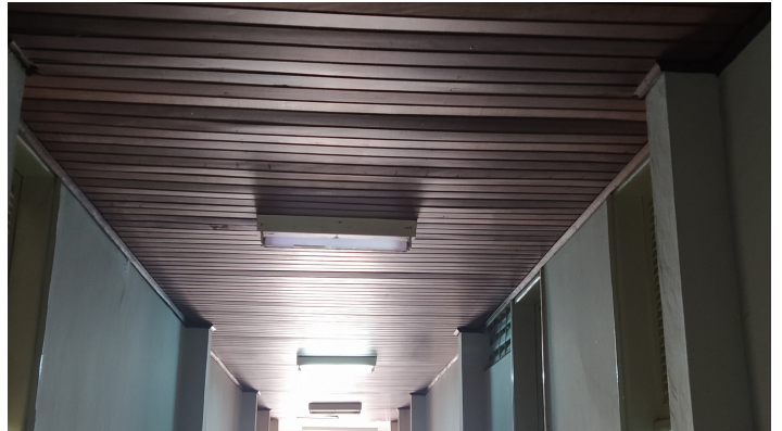
Foto 4: Corredor com luzes queimadas.
