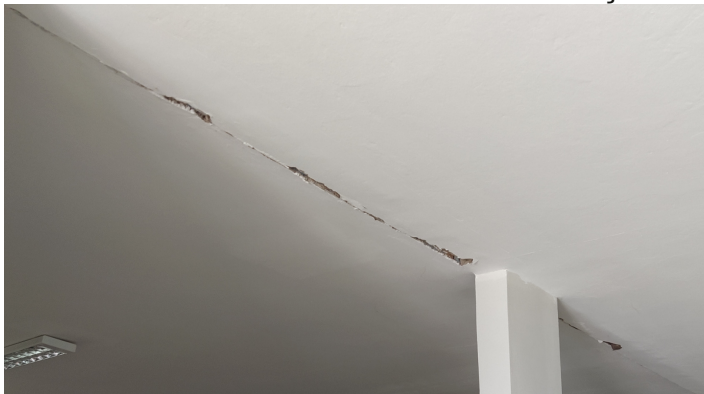
Foto 7: Rachadura no teto.
