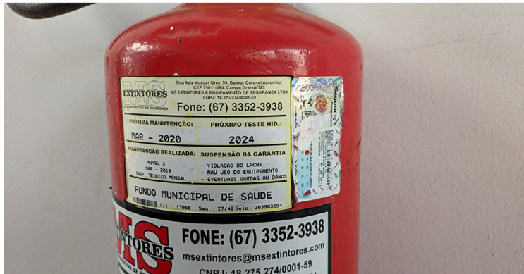
Foto 3 Extintor com manutenção vencida
