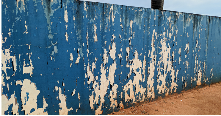
Foto 2 Parede da área externa sem manutenção
