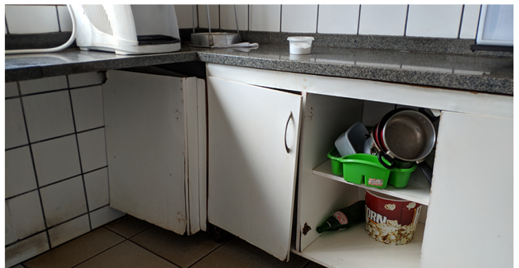
Foto 9 Armários antigos e quebrados
