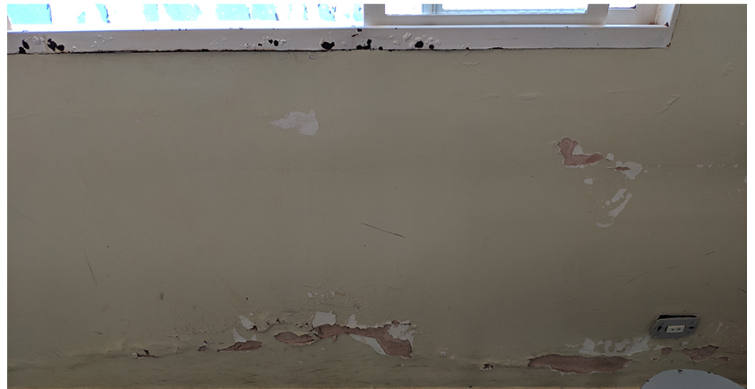
Foto 8 Ferrugem na janela e infiltração na parede
