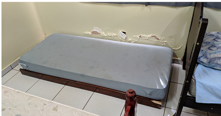
Foto 4 Cama quebrada e parede com infiltração
