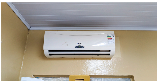
Foto 13 Ar-condicionado com defeito
