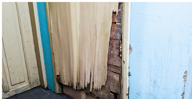
Foto 19 Porta deteriorada pela umidade
