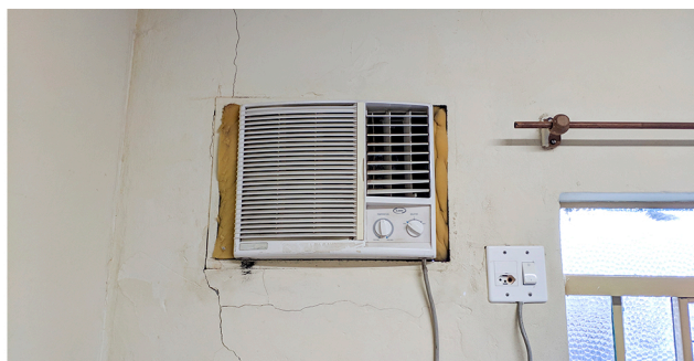
Foto 7 Ar-condicionado antigo e rachaduras
