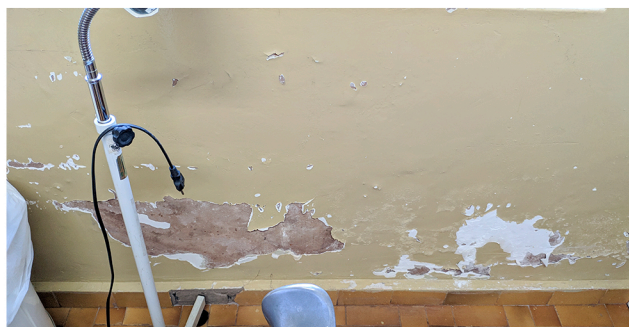
Foto 10 Parede com infiltração
