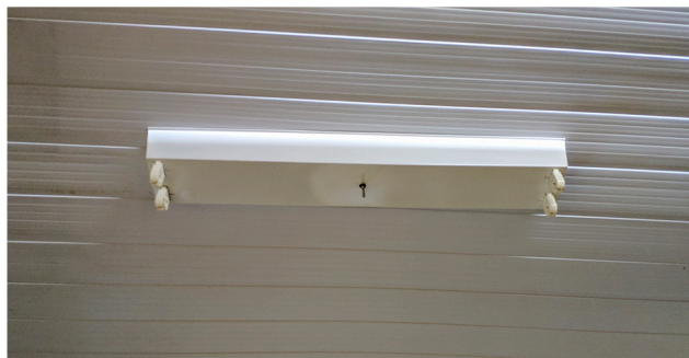
Foto 6 Falta de iluminação
