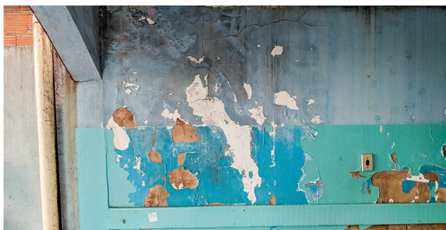
Foto 2 Parede com infiltração na recepção
