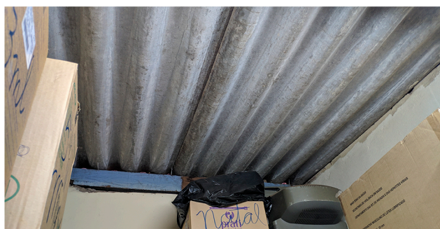
Foto 18 Almojarifado sem forro
