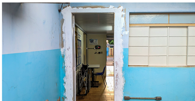
Foto 20 Paredes com rachadura
