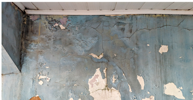
Foto 1 Parede com infiltração na recepção
