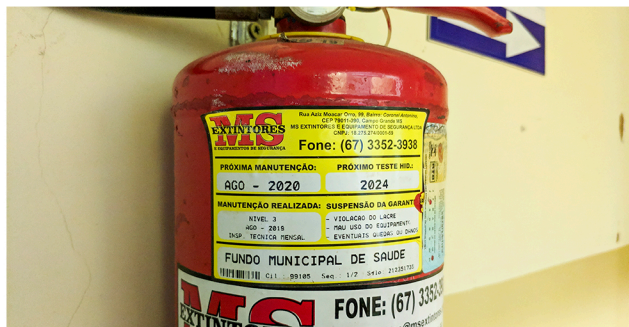
Foto 9 Extintor com manutenção vencida
