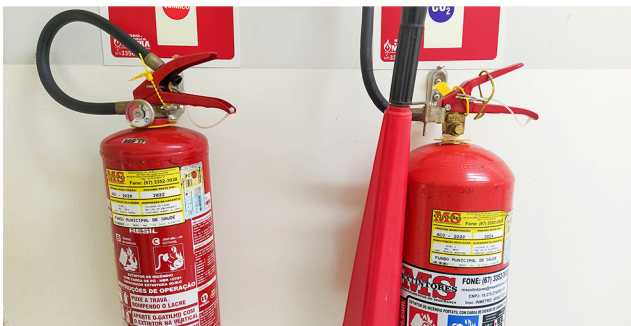
Foto 3 Extintor com a manutenção vencida
