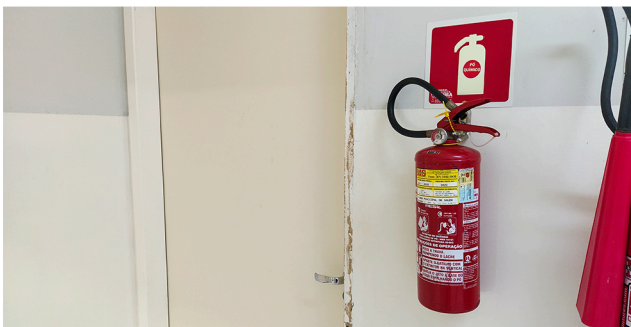
Foto 4 Extintor com a manutenção vencida
