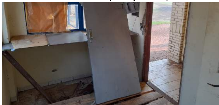
Foto 26 Portaria invadida e depredada
