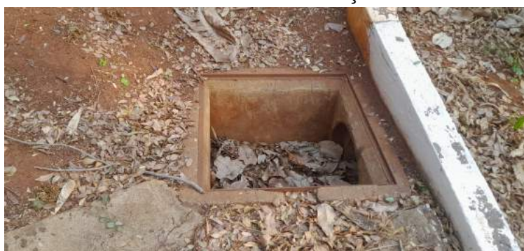
Foto 15 Ausência de grade protetora
