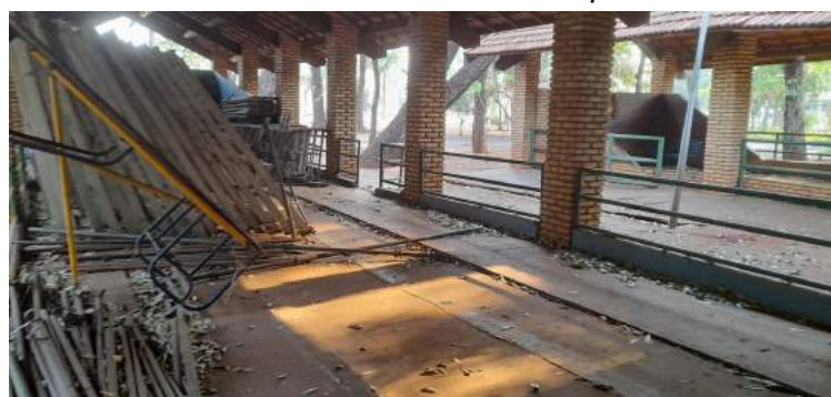
Foto 28 Entulho de arquibancada
