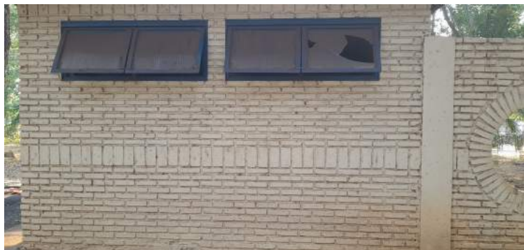
Foto 11 Janelas com vidros quebrados
