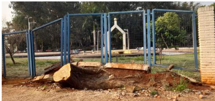
Foto 7 Proteção prejudicada devido a árvore
