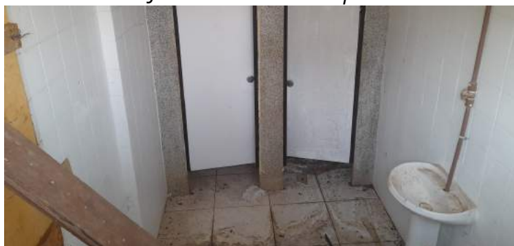
Foto 13 Banheiro sem condição de uso
