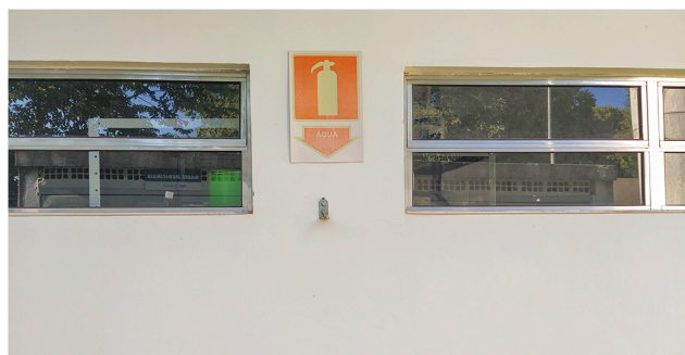
Foto 9 Falta de extintor
