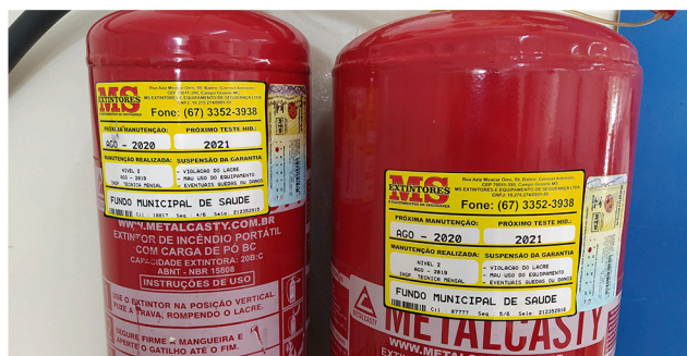
Foto 8 Extintor com manutenção vencida
