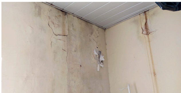
Foto 4 Paredes com infiltração
