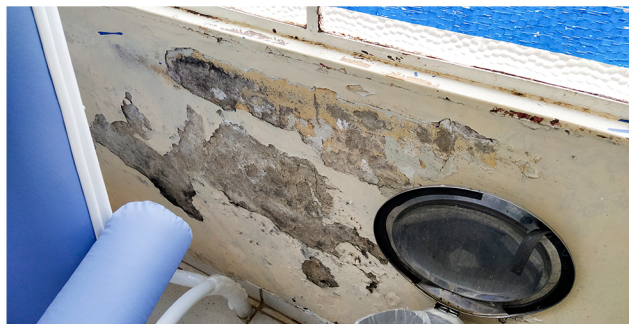
Foto 8 Paredes com infiltração
