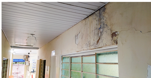
Foto 10 Paredes com infiltração
