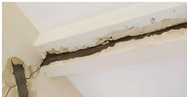
Foto 6 Estrutura com rachaduras
