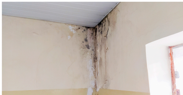
Foto 7 Paredes com infiltração
