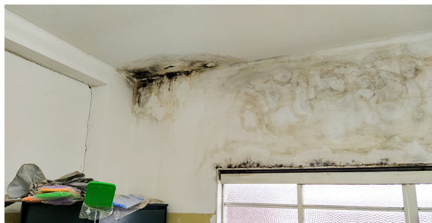
Foto 9 Paredes com infiltração
