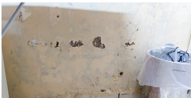
Foto 5 Paredes com infiltração
