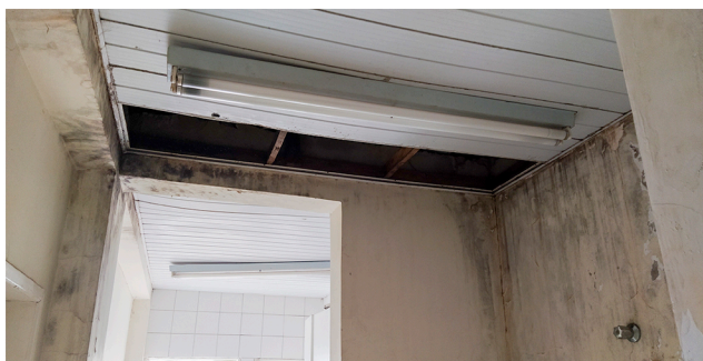
Foto 15 Infiltração e teto sem forro na copa
