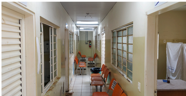
Foto 2 Corredor sem acessibilidade
