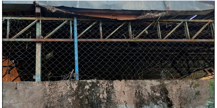
FOTO 6 MURO EXTERNO EM PÉSSIMO ESTADO
