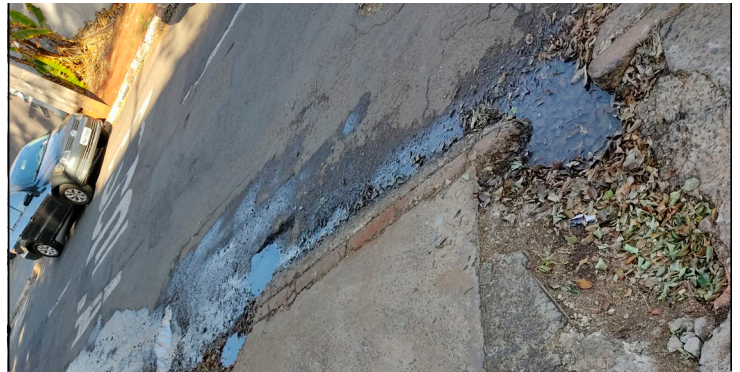
FOTO 8 VAZAMENTO DE ÁGUA EXTERNO
