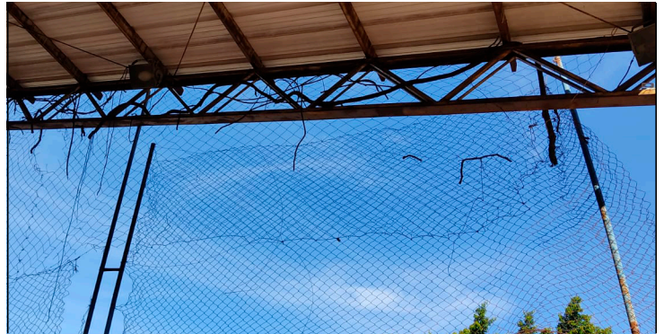
FOTO 4 REDES DE PROTEÇÃO SE DETERIORANDO
