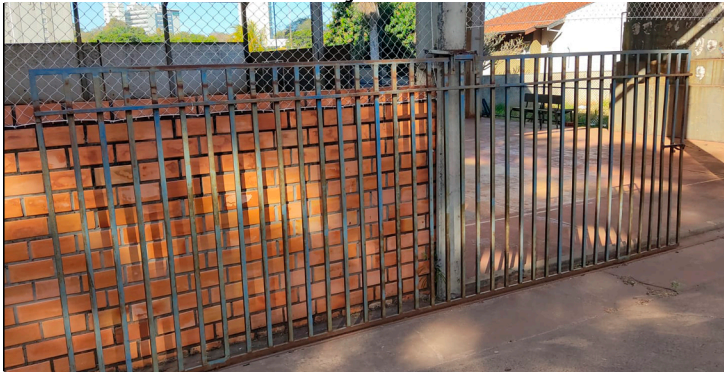
FOTO 3 PORTÕES COM MAL FUNCIONAMENTO
