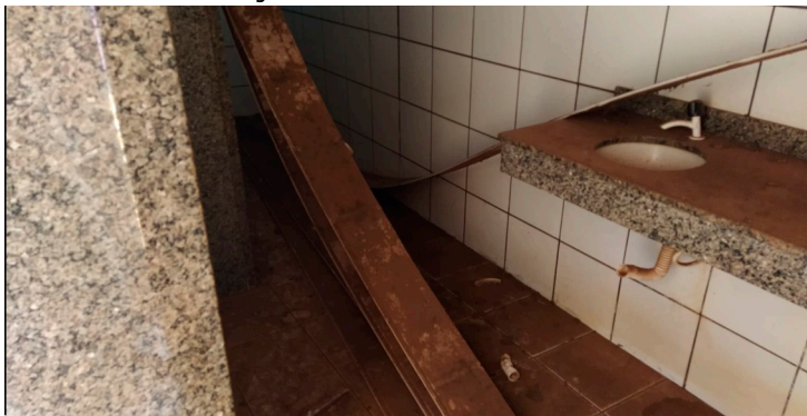
FOTO 17 BANHEIROS EM PÉSSIMO ESTADO ESTRUTURAL
