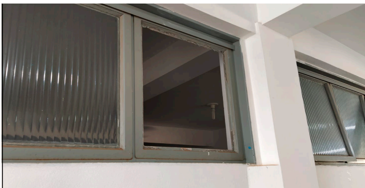
FOTO 19 JANELAS PEQUENAS E EMPERRADAS
