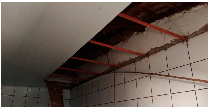
FOTO 20 BANHEIROS INTERDITADOS - ANEXO
