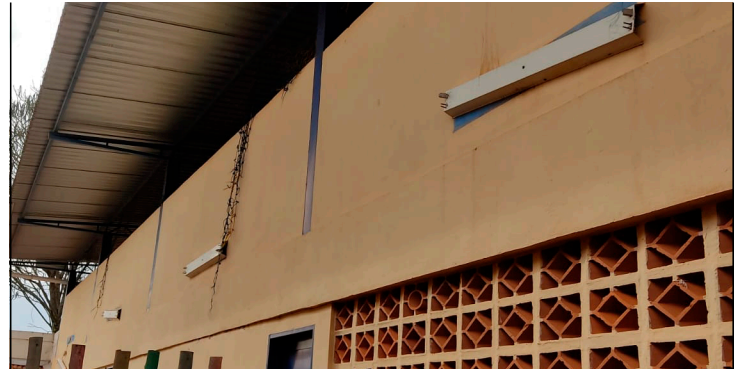
FOTO 16 FALTA DE ILUMINAÇÃO
