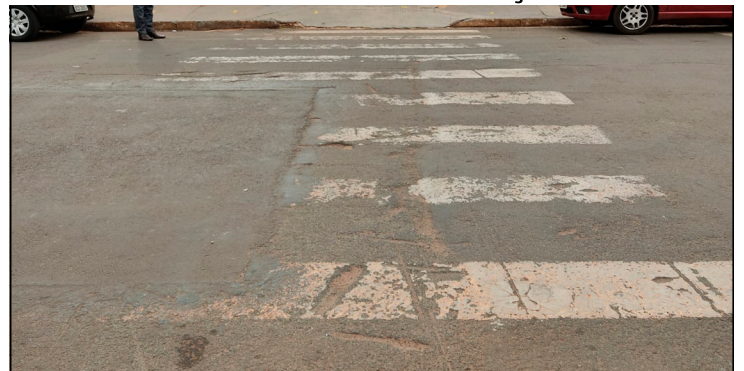
FOTO 18 NECESSIDADE DE FAIXA ELEVADA
