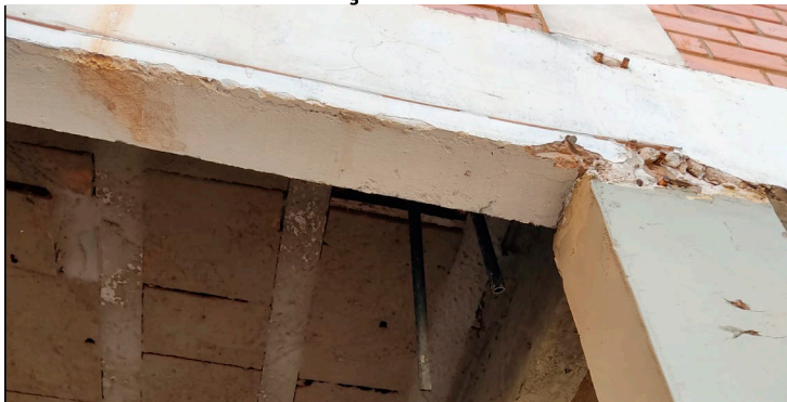
FOTO 13 VIGAS DE SUSTENTAÇÃO COMPROMETIDA
