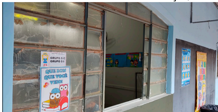
FOTO 26 JANELAS EM PÉSSIMO ESTADO
