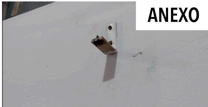
FOTO 22 TODOS OS EXTINTORES EM MANUTENÇÃO
