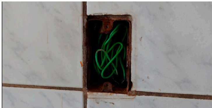
FOTO 21 FIAÇÃO EXPOSTA POR TODO ANEXO
