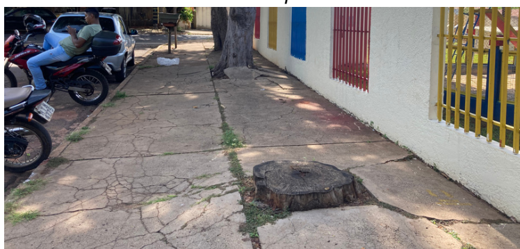
Foto 5 Calçada com rachaduras
