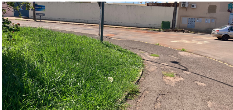
Foto 2 Pista de caminhada com buracos
