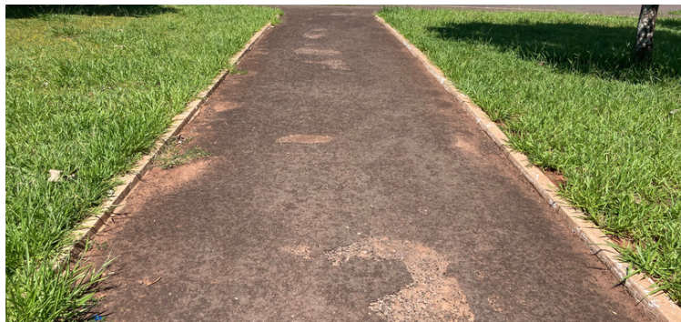
Foto 1 Pista de caminhada deteriorada
