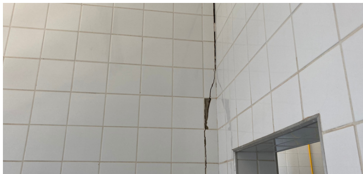
Foto 2 Rachadura na sala
