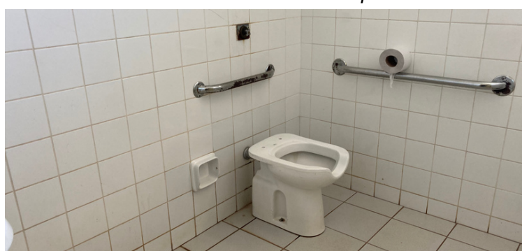
Foto 10 Vaso sanitário sem assento
