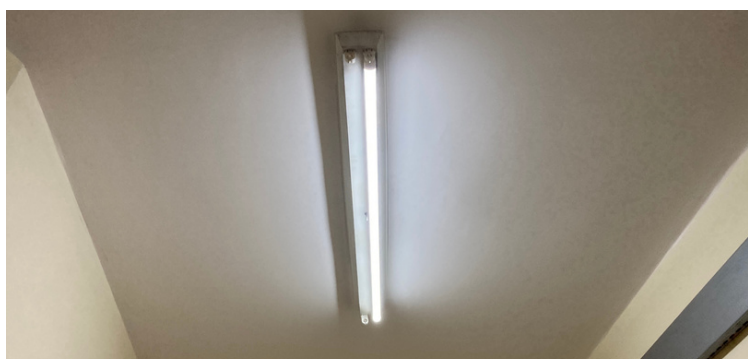
Foto 5 Falta de lâmpada na luminária
