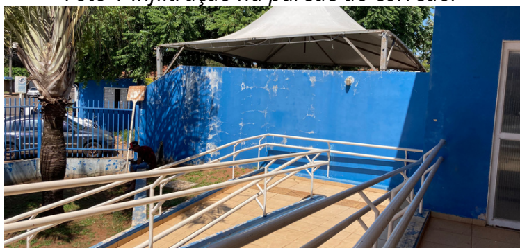
Foto 3 Parede da área externa descascando
