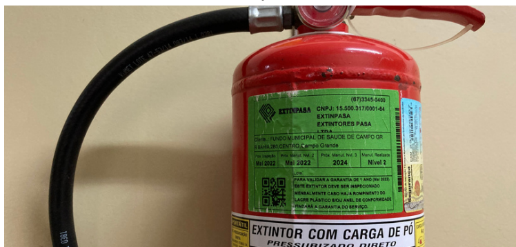
Foto 7 Extintores da unidade
