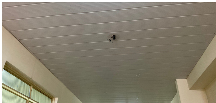
Foto 4 Falta de luminária no corredor
