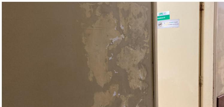
Foto 1 Infiltração na parede do corredor
