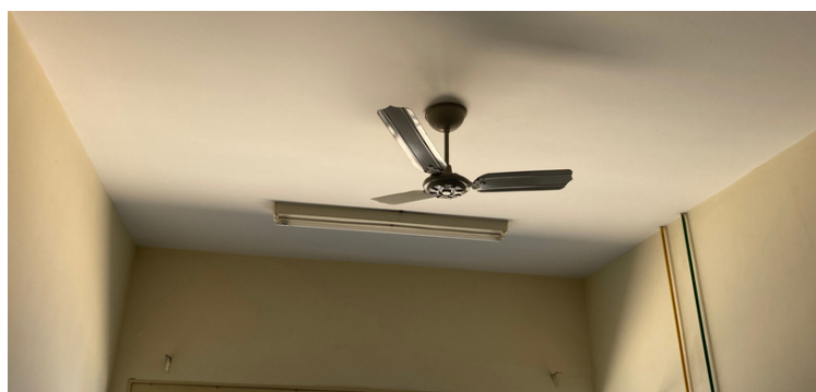
Foto 6 Ventilador com defeito
