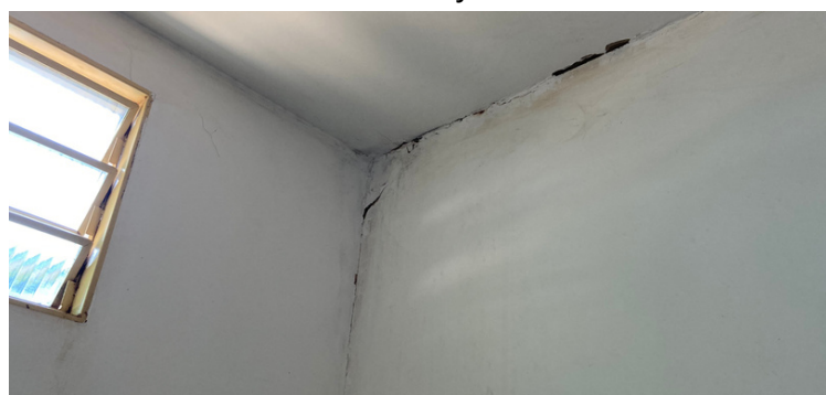
Foto 18 Infiltração nas salas
