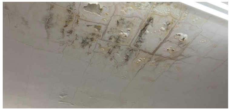
Foto 2 Infiltrações no teto com mofo
