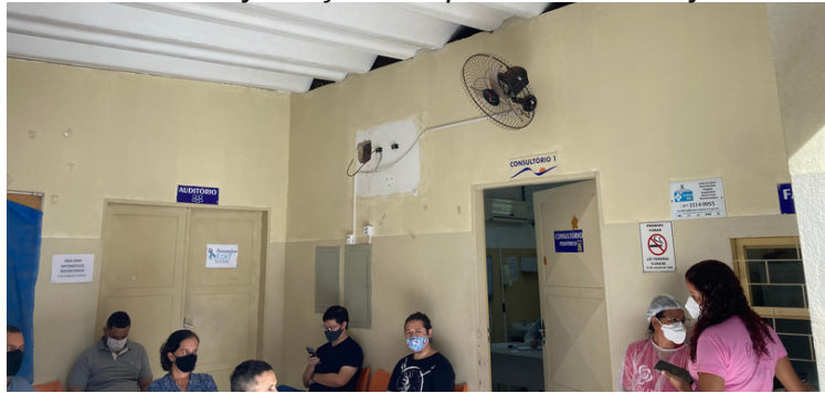
Foto 3 Sala de espera com ventilador estragado
