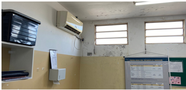
Foto 1 Infiltrações na parede com mofo
