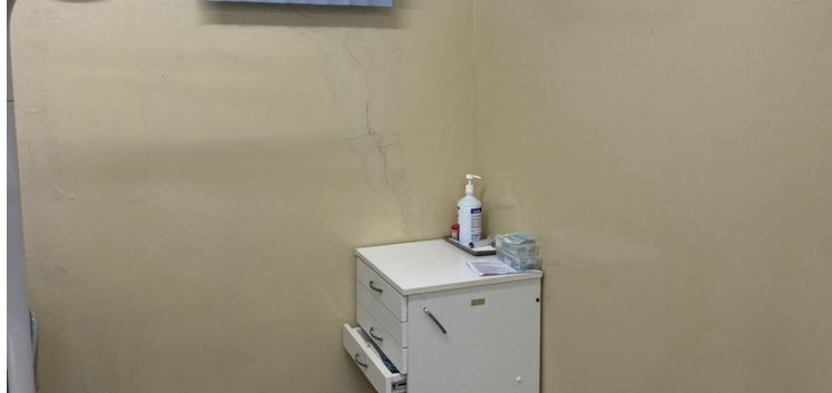
Foto 5 Sala de odontologia com rachaduras
