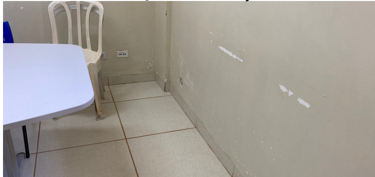
Foto 3 infiltração na parede da sala
