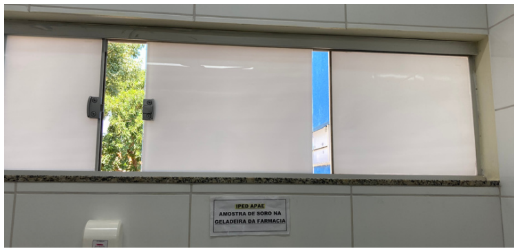
Foto 1 Janela com defeito
