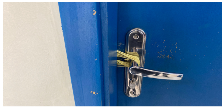
Foto 2 fechadura com defeito
