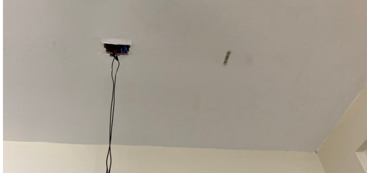
Foto 5 Problemas na parte elétrica
