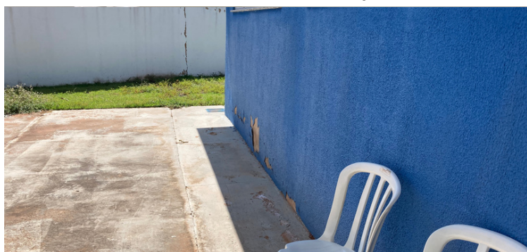
Foto 9 Infiltração na parte externa
