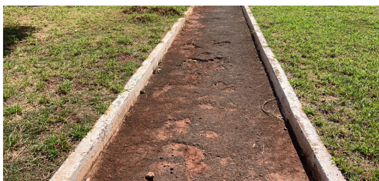
Foto 9 Pista de caminhada deteriorada
