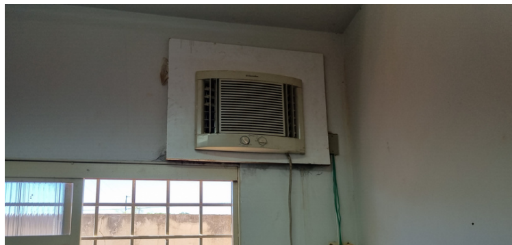
Foto 12 Ar-condicionado sem condições de uso
