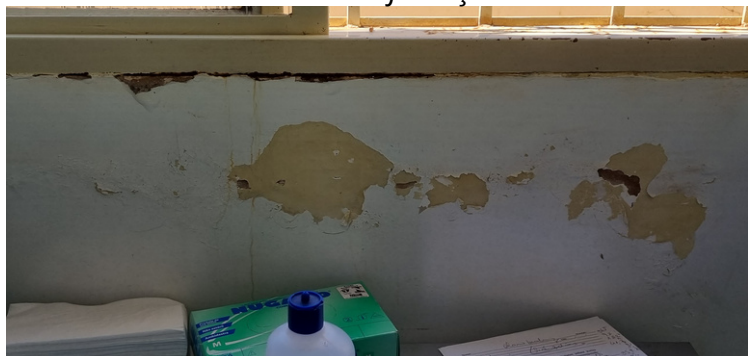
Foto 13 Parede sem manutenção
