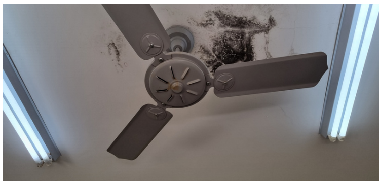
Foto 5 Infiltração no teto
