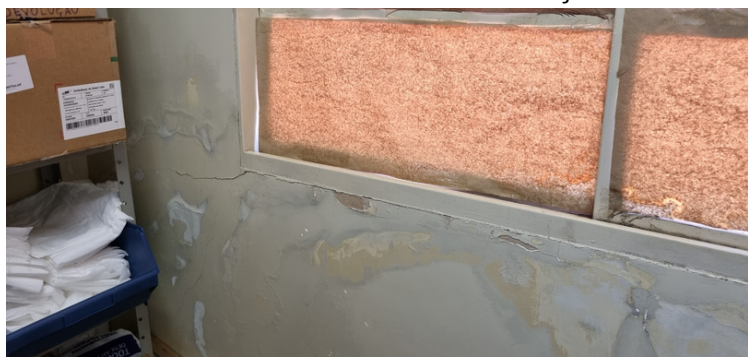
Foto 15 Infiltração nas paredes
