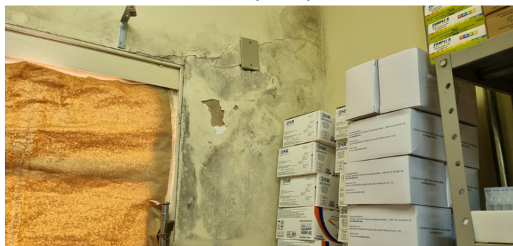
Foto 8 Infiltração no almoxarifado
