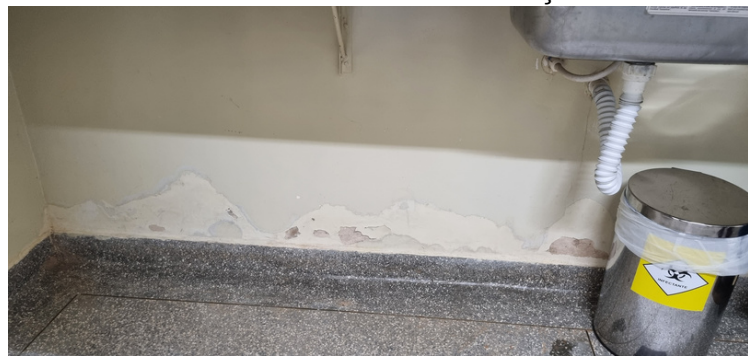
Foto 14 Infiltração na unidade
