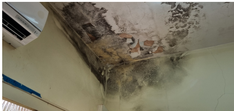
Foto 4 Infiltração no consultório
