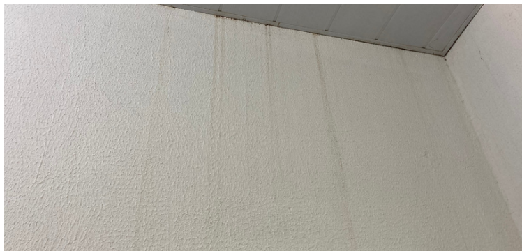
Foto 1 Água escorrendo pela parede
