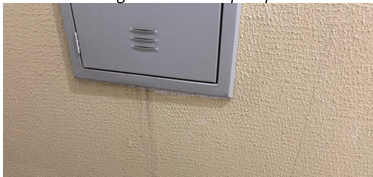
Foto 3 Água escorrendo no padrão de energia
