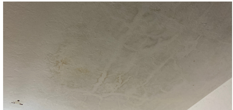
Foto 4 - Teto do refeitório com manchas evidentes de infiltração.
