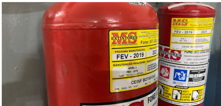
Foto 5 - Extintores com datas de validade expiradas.
