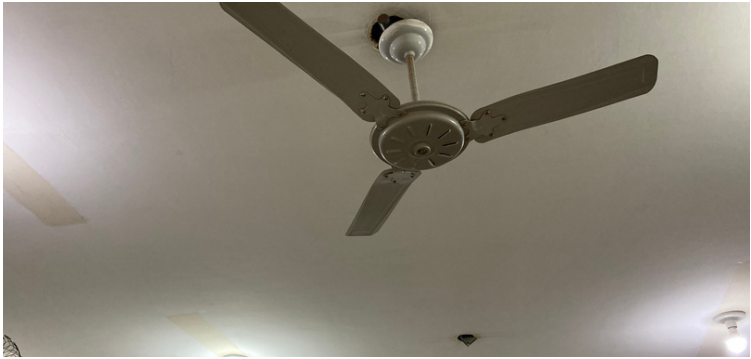
Foto 3 - Ventiladores carentes de manutenção.
