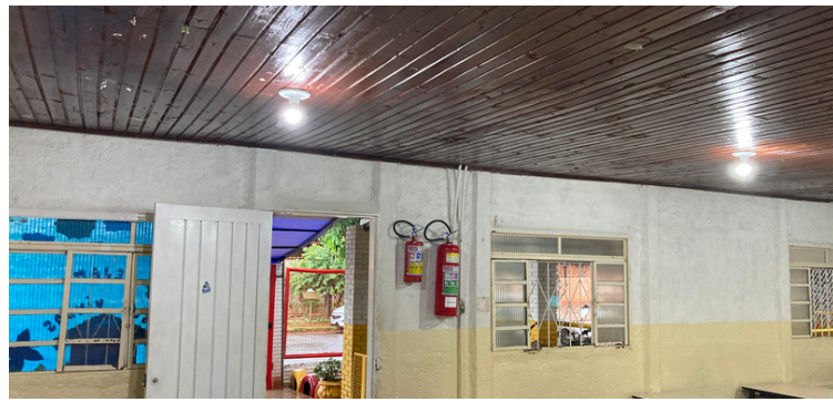
Foto 2 - Recepção do ceinf necessitando de ventilação
