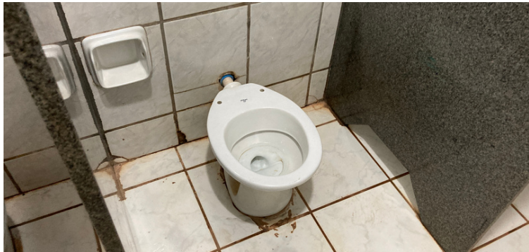
Foto 6 - Banheiros ausentes de tampas sanitárias.
