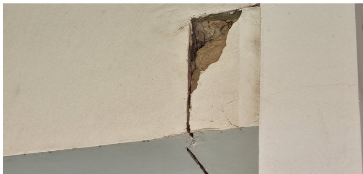
Foto 2 - Rachaduras pontuais nas dependências da unidade
