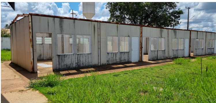
Foto 4 - Salas de aulas inacabadas e inutilizadas
