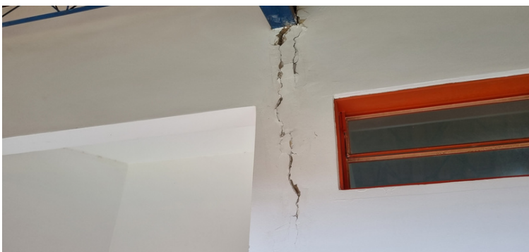
Foto 8 - Fissuras localizadas em determinados locais da escola
