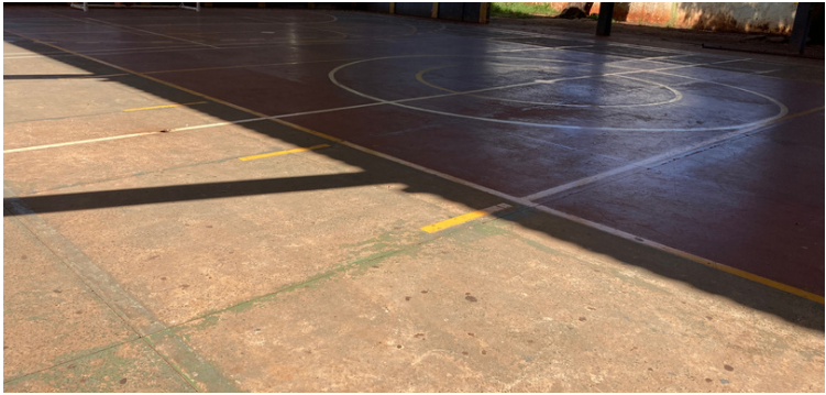
Foto 3 Pintura da quadra de esportes antiga e está apagada.
