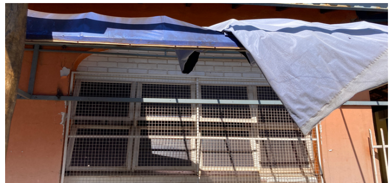
Foto 8 Toldo de proteção danificado.
