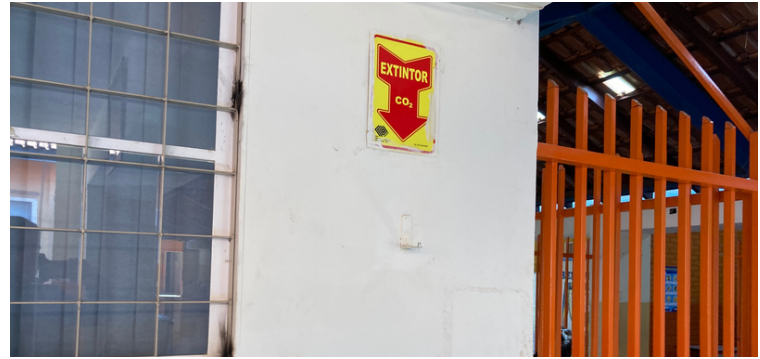
Foto 4 Ausência de extintores de incêndio.
