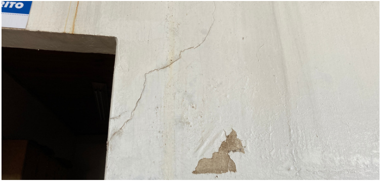
Foto 3 - Fissuras e rachaduras nas paredes da unidade
