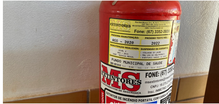
Foto 4 - Extintores com a data de validade vencida
