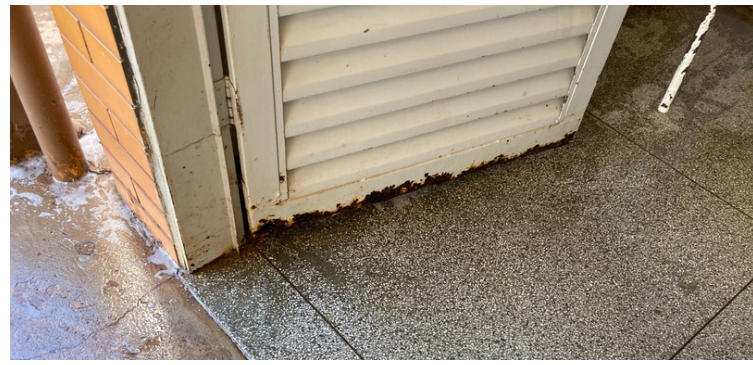
Foto 2 - Ferrugem se alastrando nas portas
