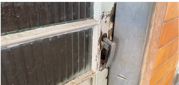
Foto 7 - Portas avariadas necessitando de manutenção
