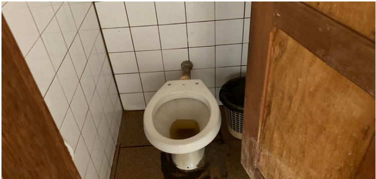
Foto 5 - Banheiros sem higienização e manutenção
