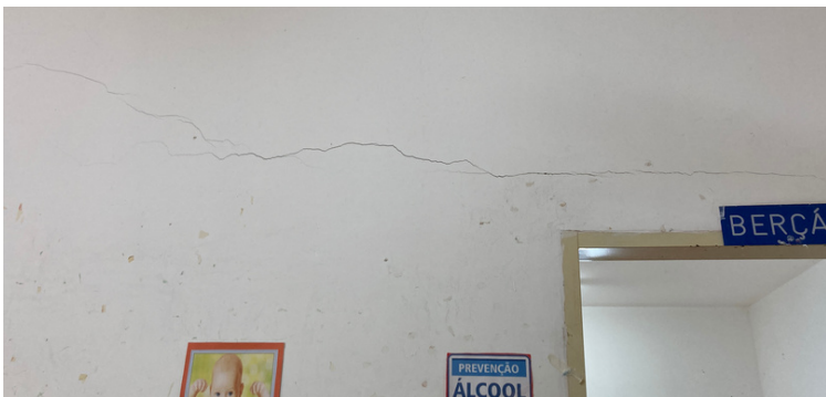
Foto 5 Rachadura na parede próximo a porta do berçário.
