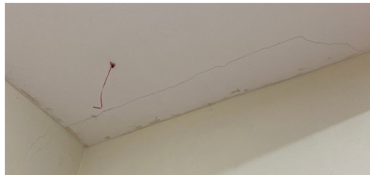
Foto 6 Rachadura no teto do berçário.
