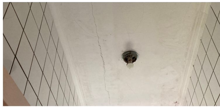
Foto 2 Rachadura no teto do corredor.
