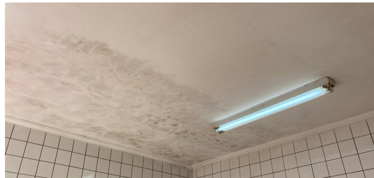
Foto 4 Infiltração no teto da sala de aula.
