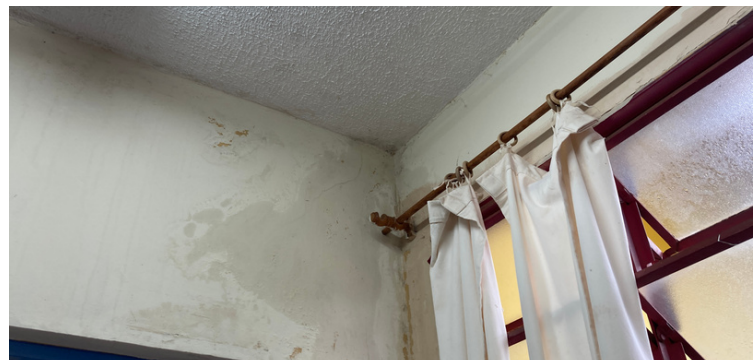
Foto 2 - Processo de infiltração em locais pontuais da unidade
