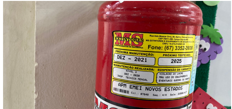
Foto 8 - Extintores com a data de validade vencida
