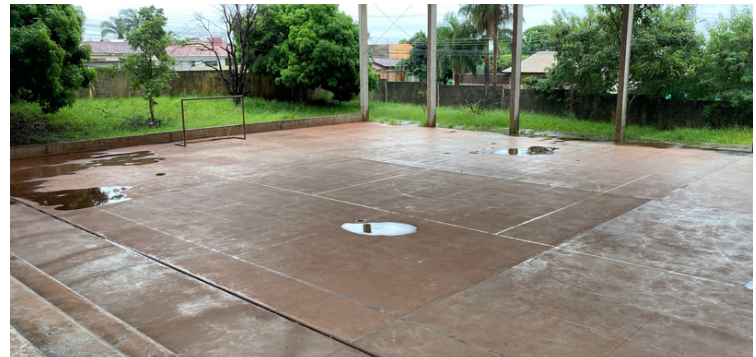
Foto 6 - Quadra esportiva necessitando de revitalização
