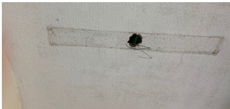
Foto 9 - Ausência de luminárias deixando a fiação exposta
