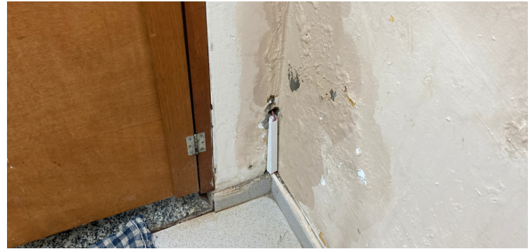
Foto 4 - Infiltração comprometendo a rede elétrica
