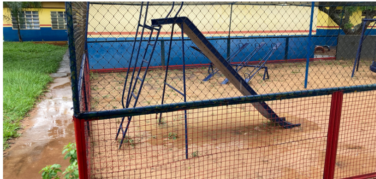
Foto 7 - Parquinho do ceinf carece de cobertura
