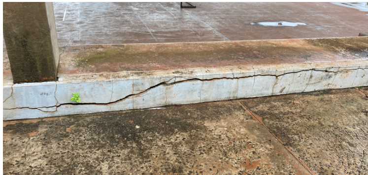
Foto 5 - Falha considerável na estrutura da quadra
