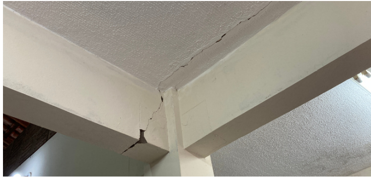
Foto 3 - Estrutura constante de rachaduras
