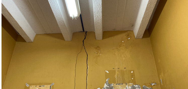
Foto 5 - Rachaduras comprometendo a estrutura do prédio
