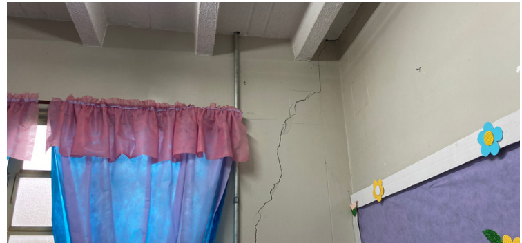
Foto 8 - Salas de atendimento acometidas por rachaduras
