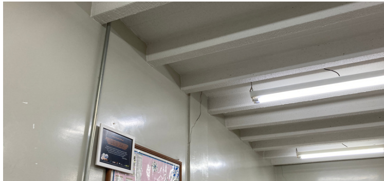
Foto 7 - Fissuras nas paredes do CRAS
