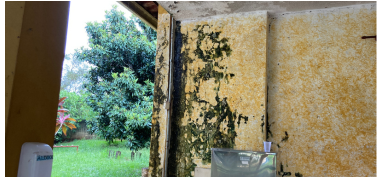
Foto 4 - Mofo alastrado na maioria das dependências do CRAS
