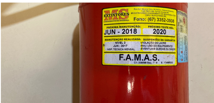
Foto 4 - Extintores com as datas de validade expiradas
