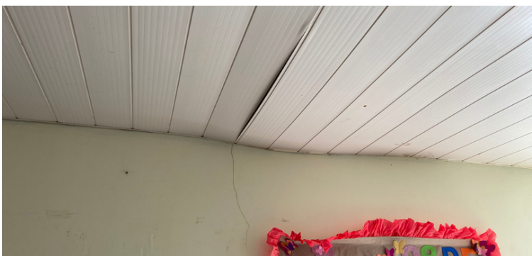
Foto 5 - Forro empenado na recepção da unidade
