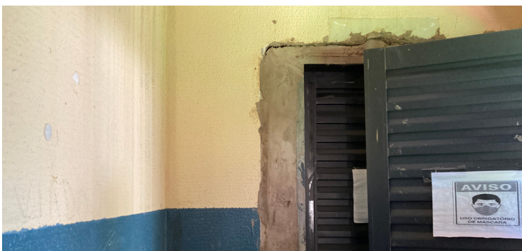
Foto 6 - Rachaduras indicativas da malfeita instalação das portas
