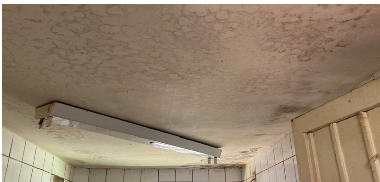
Foto 7 - Banheiros isentos das devidas condições de utilização
