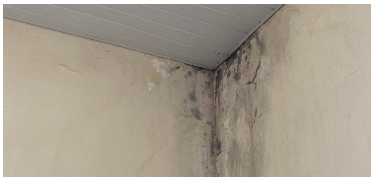
Foto 5 - Paredes da unidade repleta de mofo
