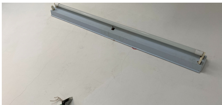
Foto 9 - Luminárias sem lâmpadas e fiação exposta
