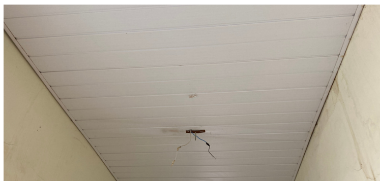
Foto 10 - Rede elétrica sem a devida instalação
