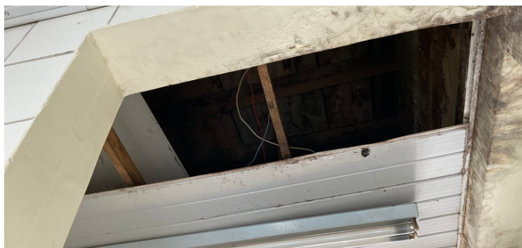
Foto 7 - Forro da UBS avariado
