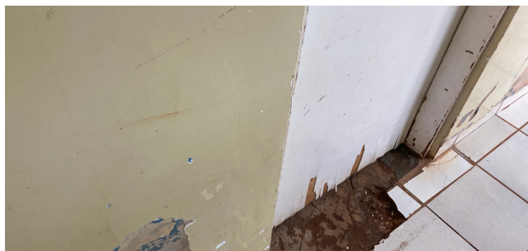
Foto 8 - Assoalhos com pisos quebrados
