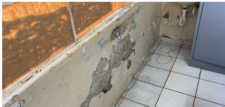
Foto 4 - Infiltrações alastradas pelas dependências da UBS
