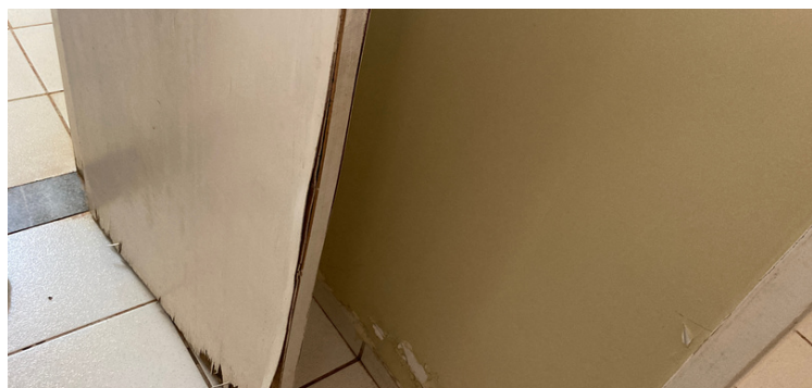
Foto 6 - Portas da repartição encontram-se deterioradas
