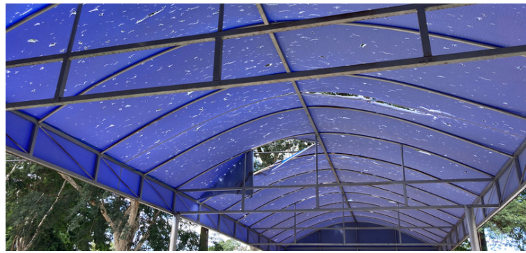
Foto 2 - Toldo instalado na entrada da unidade, encontra-se avariado
