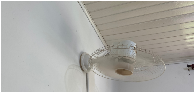
Foto 5 - Ventiladores sem a devida proteção, incorrendo em acidentes
