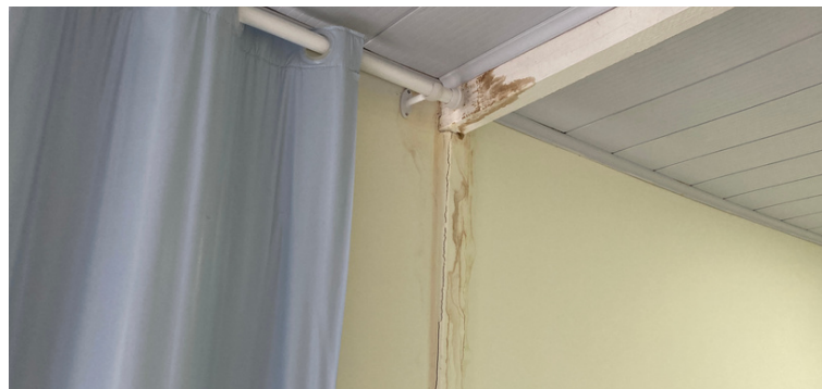
Foto 8 - Infiltrações em locais pontuais da escola
