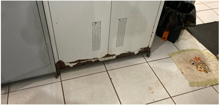
Foto 3 - Armários da unidade enferrujados
