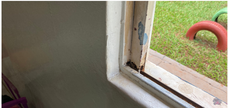
Foto 6 - Ferrugem se alastrando nas janelas
