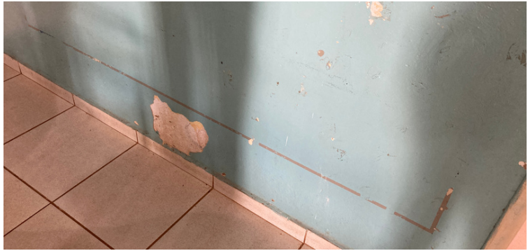
Foto 4 - Pintura da escola necessitando revitalização
