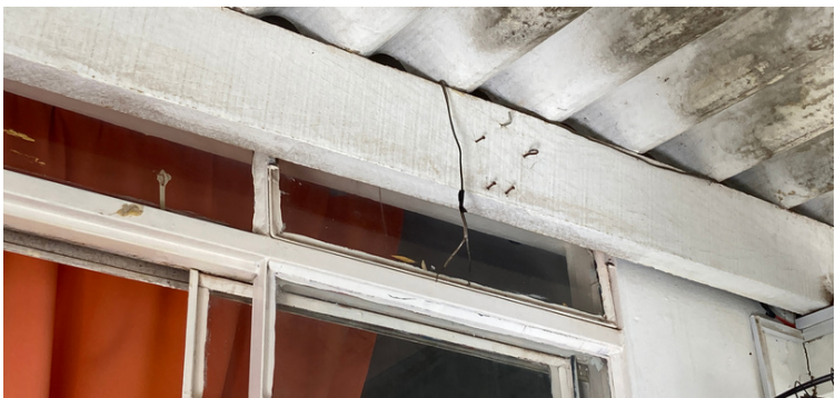
Foto 7 - Aparecimento de mofo no teto da instituição
