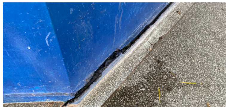
Foto 8 Fissura espessa no rodapé.
