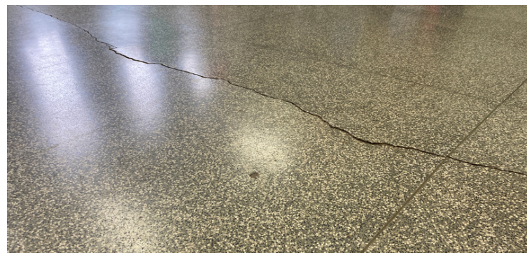
Foto 2 Piso da sala 24 com rachadura.
