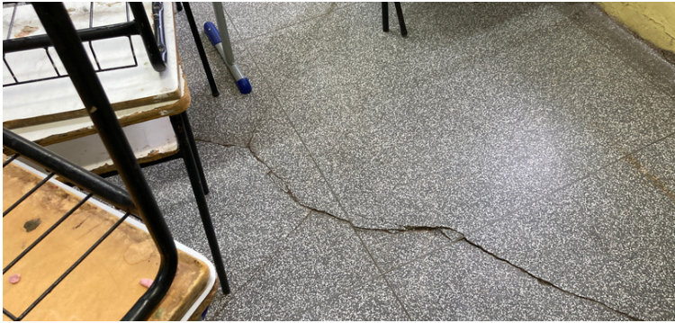
Foto 3 Piso da sala 24 cedeu e causou rachaduras.
