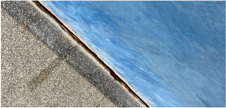
Foto 11 Rachadura causada pelo deslocamento do piso.
