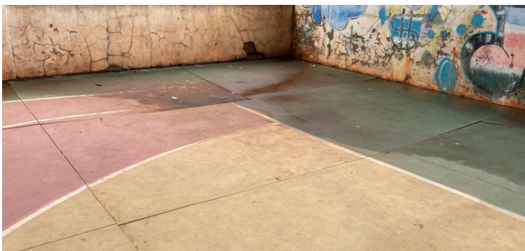
Foto 20 Piso cedendo na quadra de esportes.
