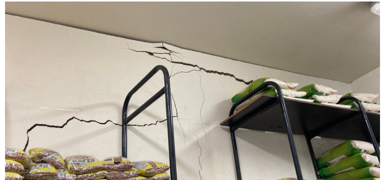
Foto 14 Rachaduras espessas no depósito da cozinha.
