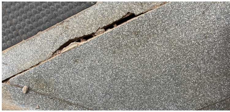
Foto 9 Piso cedendo no corredor da unidade escolar.
