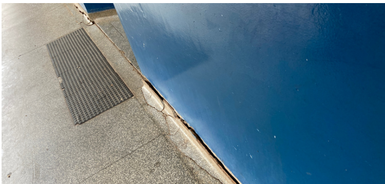
Foto 5 Estrutura do piso cedeu e causou fissura no rodapé.
