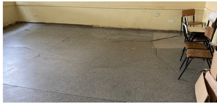
Foto 10 Sala de aula desativada por conta do piso estar cedendo.
