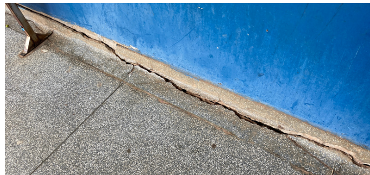
Foto 6 Fissura entre a parede e o piso no corredor.
