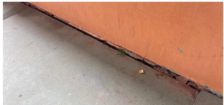
Foto 16 Fissura na quadra de esportes.
