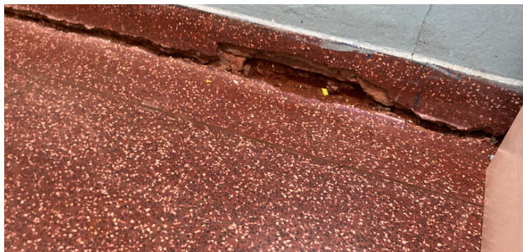
Foto 11 Rachadura no piso da sala de aula
