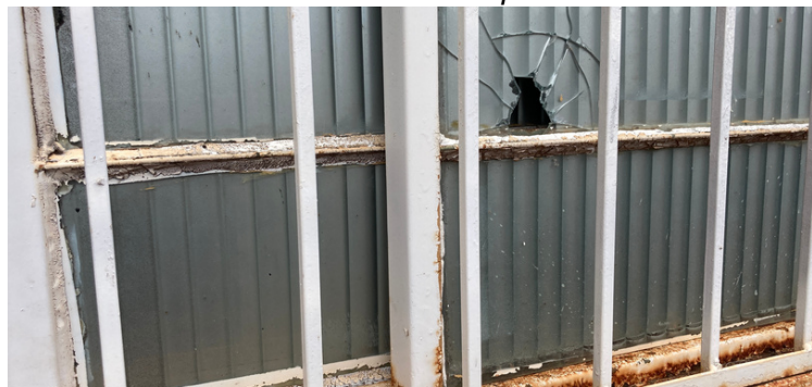
Foto 24 Vidro da janela quebrado
