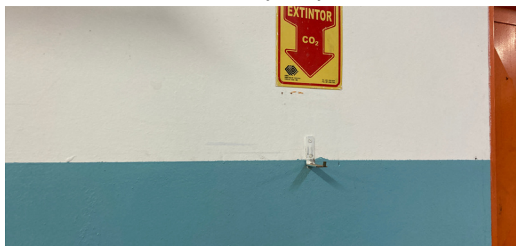
Foto 20 Falta de extintor de incêndio
