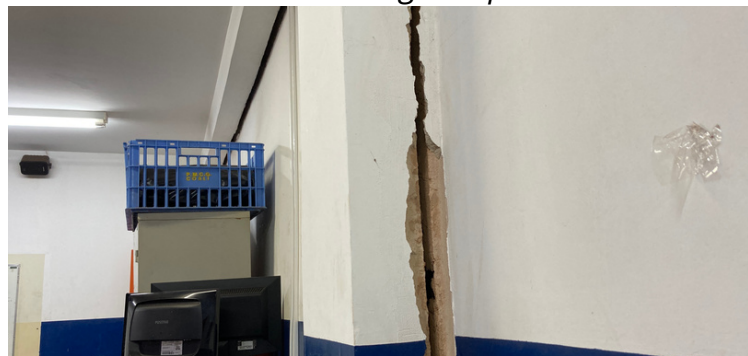
Foto 4 Rachadura na parede
