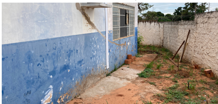
Foto 19 Rachaduras na parte externa
