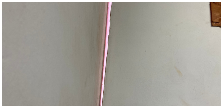
Foto 22 Fissura na parede
