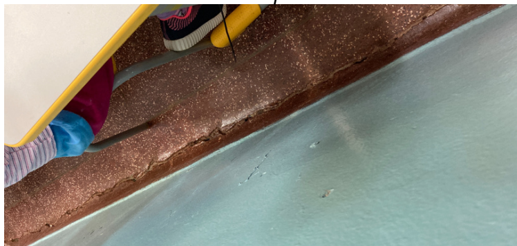
Foto 13 Rachadura próximo a cadeira do aluno
