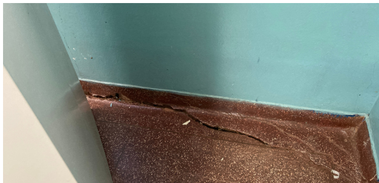
Foto 12 Rachadura no piso
