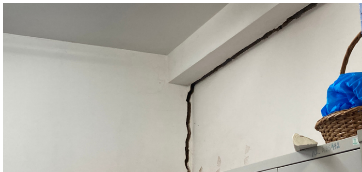
Foto 3 Rachaduras na sala
