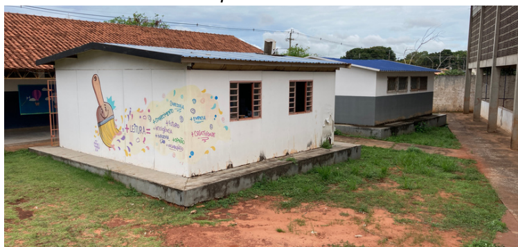
Foto 15 Problema estrutural na biblioteca
