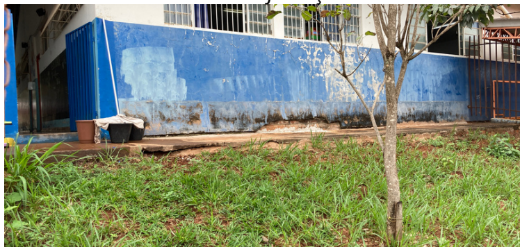
Foto 23 Infiltrações na parte externa
