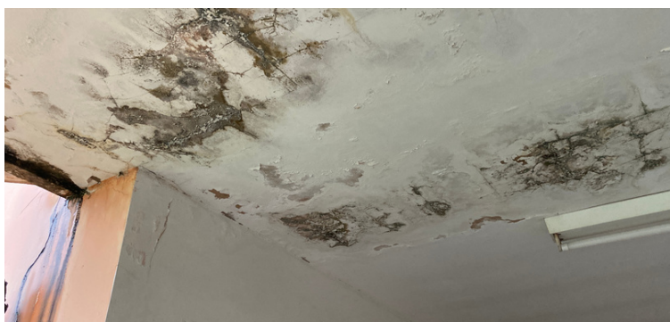
Foto 4 Infiltração com presença de mofo no corredor.
