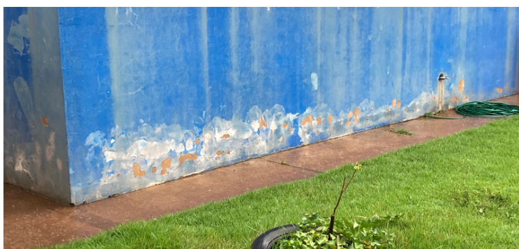
Foto 6 Pintura descascada na área externa da escola.
