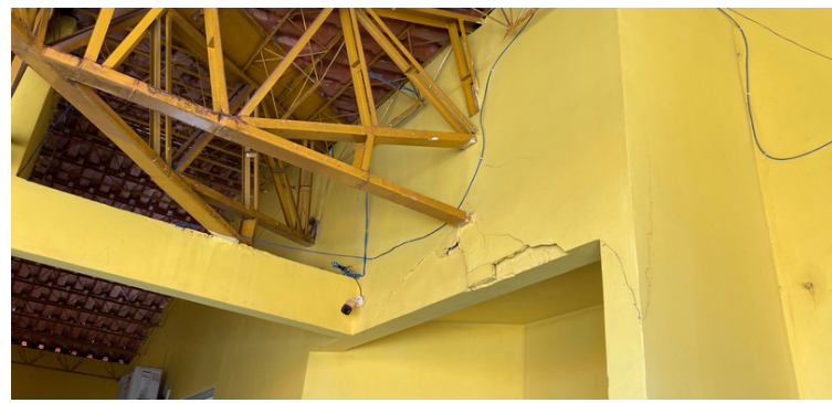
Foto 2 Rachaduras na parede próximo à secretaria da escola.
