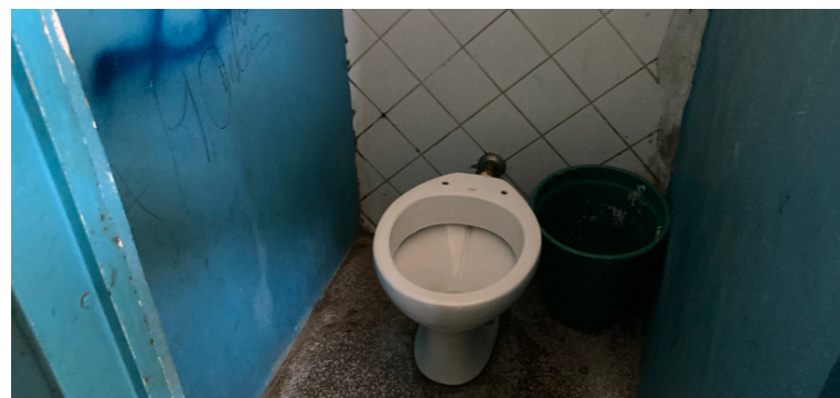
Foto 8 Vaso sanitário do banheiro sem assento e tampa.
