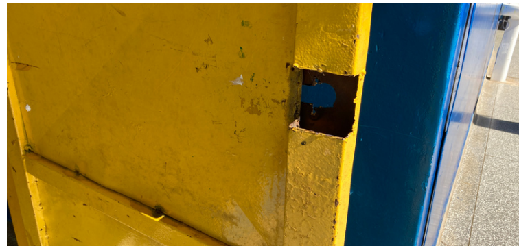
Foto 4 Portas das salas de aula com a fechadura danificada.
