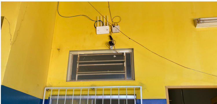
Foto 3 Fiação exposta próximo as salas da educação infantil.
