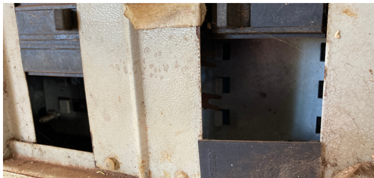
Foto 3 Padrão de energia sem fixação
