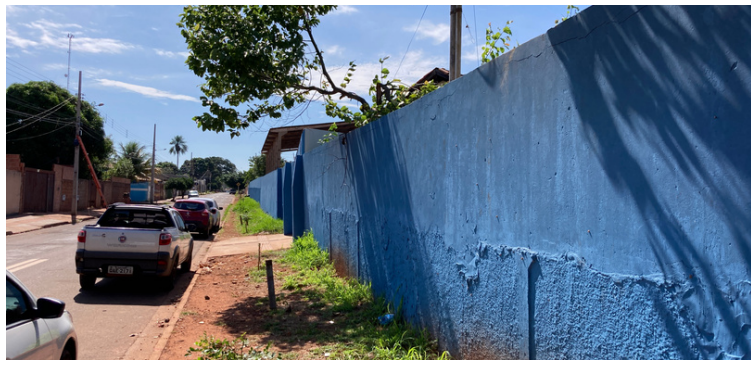
Foto 9 Falta de pavimento na calçada lateral da escola e área verde com necessidade de manutenção.
