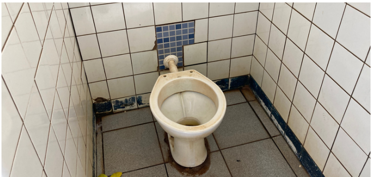
Foto 3 Vaso sanitário do banheiro sem tampa e assento.
