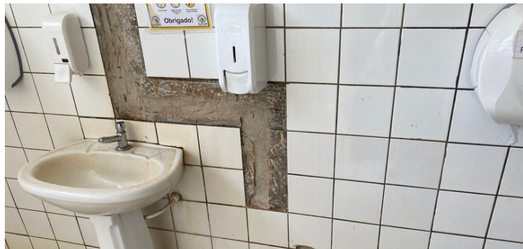
Foto 4 Parede do banheiro quebrada, faltando azulejos.
