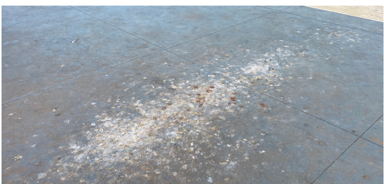
Foto 7 Fezes de pombos que acabam por corroer a pintura nova da quadra de esportes.
