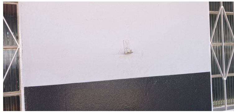
Foto 2 Local para fixação de extintor de incêndio, porém não estão fixados nos ganchos.
