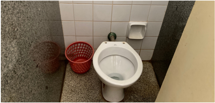
Foto 3 Vaso sanitário do banheiro masculino sem assento e tampa.
