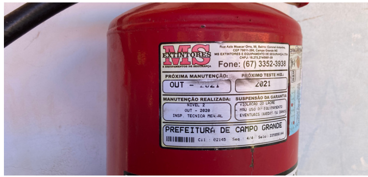
Foto 2 Extintor de incêndio com prazo de validade vencido.
