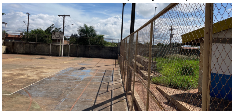
Foto 7 Pintura apagada na quadra de esportes
