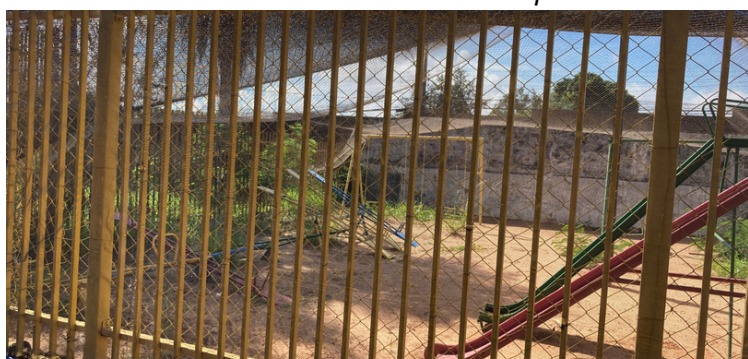
Foto 15 Parquinho sem manutenção
