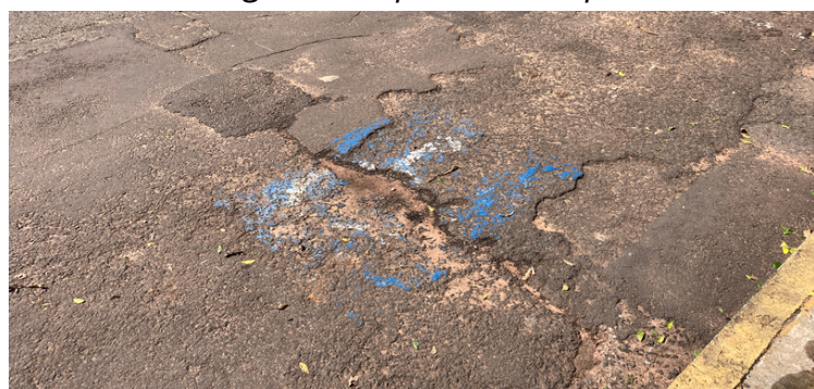
Foto 8 Sinalização da via sem manutenção
