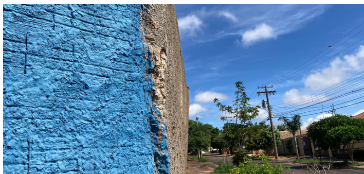
Foto 13 Muro com risco de queda
