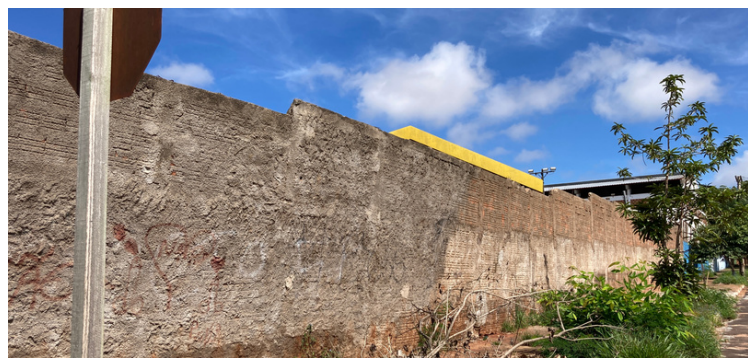
Foto 14 Muro da parte de trás da escola cedendo
