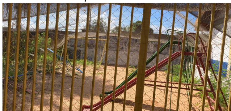
Foto 16 Brinquedos do parquinho sem manutenção
