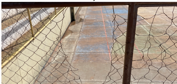
Foto 5 Buraco na tela de proteção da quadra
