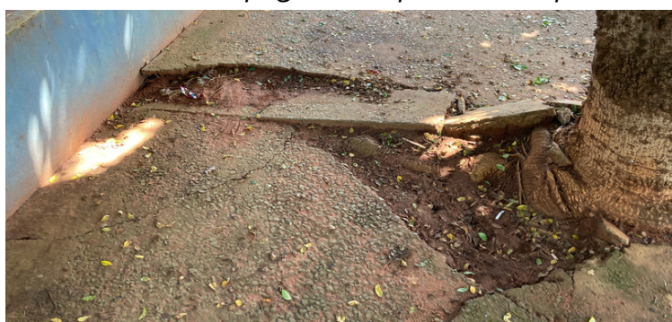
Foto 9 Calçada desnivelada na frente da escola
