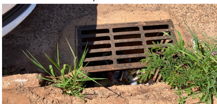
Foto 10 Bueiro sem manutenção
