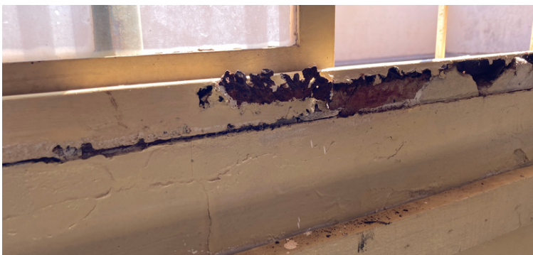
Foto 4 Batente da janela enferrujado e corroído.
