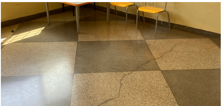
Foto 3 Rachadura em toda a extensão do piso na sala de aula.
