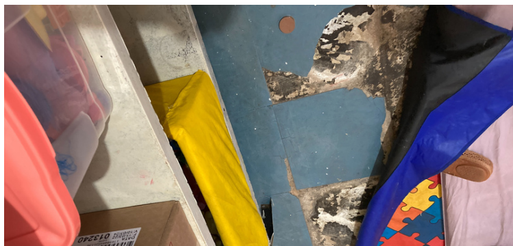
Foto 2 Piso danificado na sala de aula no segundo andar.
