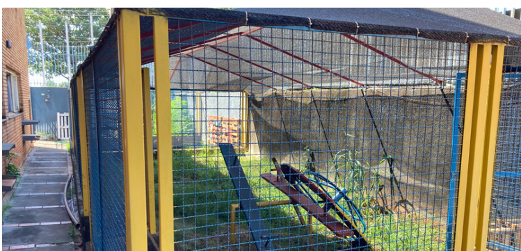
Foto 8 Parquinho interditado por falta de manutenção.
