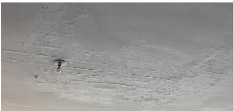
Foto 5 Infiltração no teto na sala de aula.
