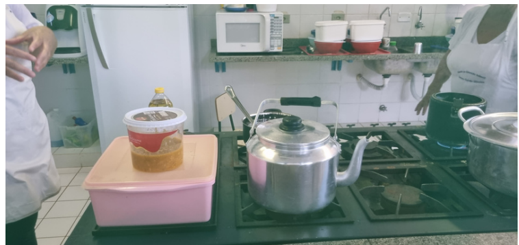
Foto 8 Fogão antigo e com vazamento de gás.
