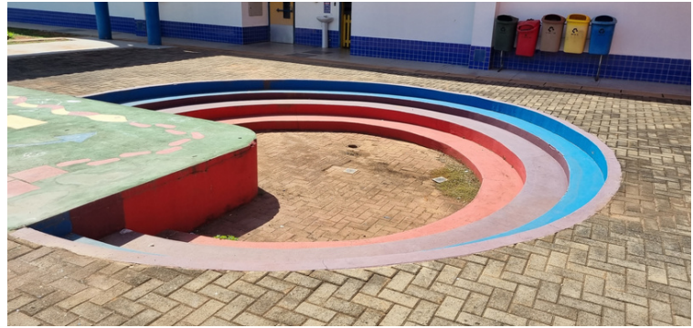
Foto 4 Teatro infantil com falta de drenagem, quando chove alaga.
