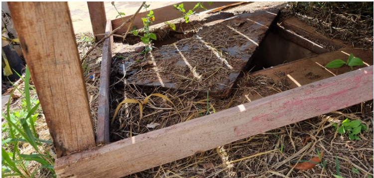
Foto 5 Proteção da caixa de fiação elétrica danificada.
