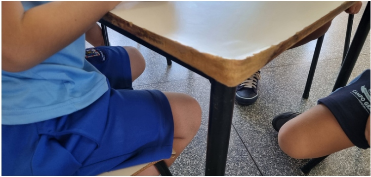
Foto 3 Mesa danificada na sala de aula.
