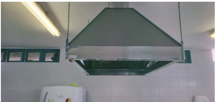
Foto 7 Exaustor na cozinha com problemas.
