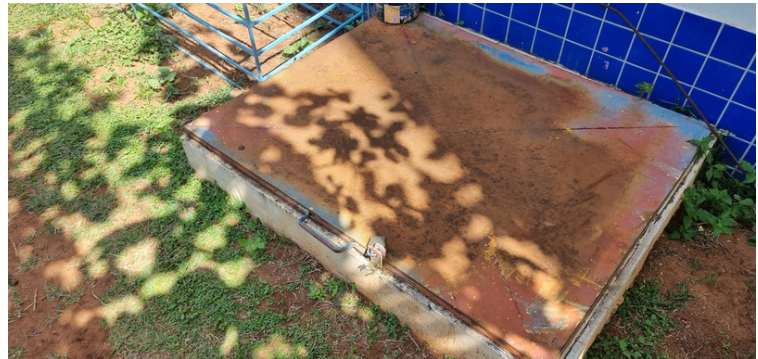
Foto 6 Ferrugem na caixa que protege a bomba d'agua.
