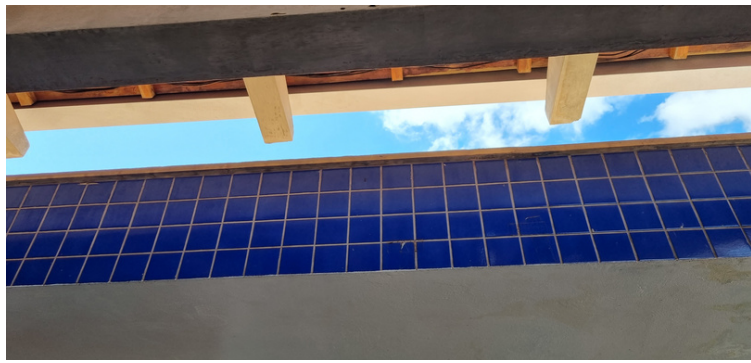
Foto 9 Abertura na estrutura do refeitório, quando chove molha os móveis.
