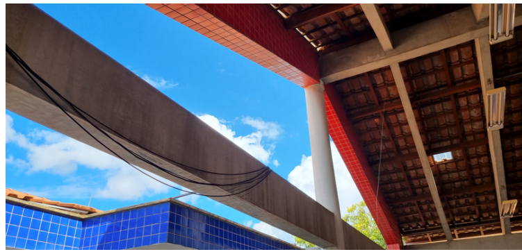
Foto 10 Grande abertura na estrutura do refeitório, quando chove molha o local.
