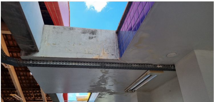
Foto 11 Pequenas infiltrações na estrutura próximo a entrada da direção da escola.
