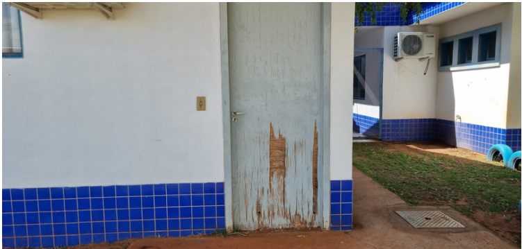
Foto 13 Porta dos fundos da sala de aula danificada.
