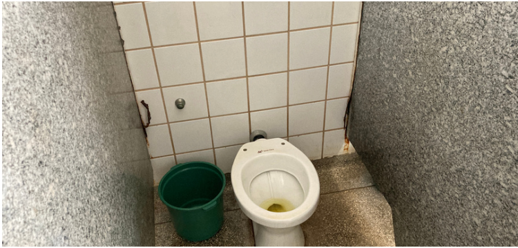
Foto 3 Vaso sanitário sem tampa e assentos nos banheiros.
