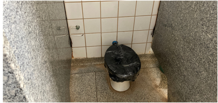
Foto 4 Vaso sanitário desativado por problemas de encanamento.
