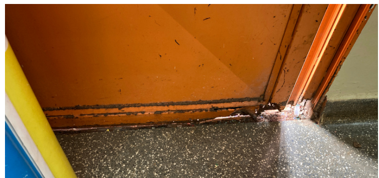
Foto 8 Porta da sala de aula corroída por ferrugem.
