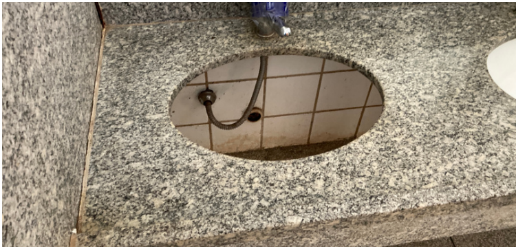
Foto 5 Pia sem cuba pois descolou da estrutura de mármore.
